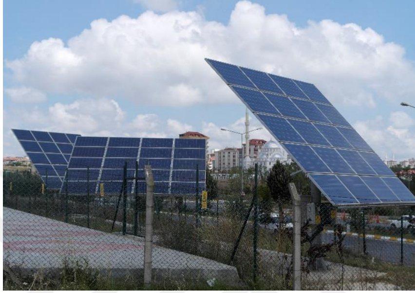
Şekil 4.1. Fotovoltaik güneş enerji santrali.
