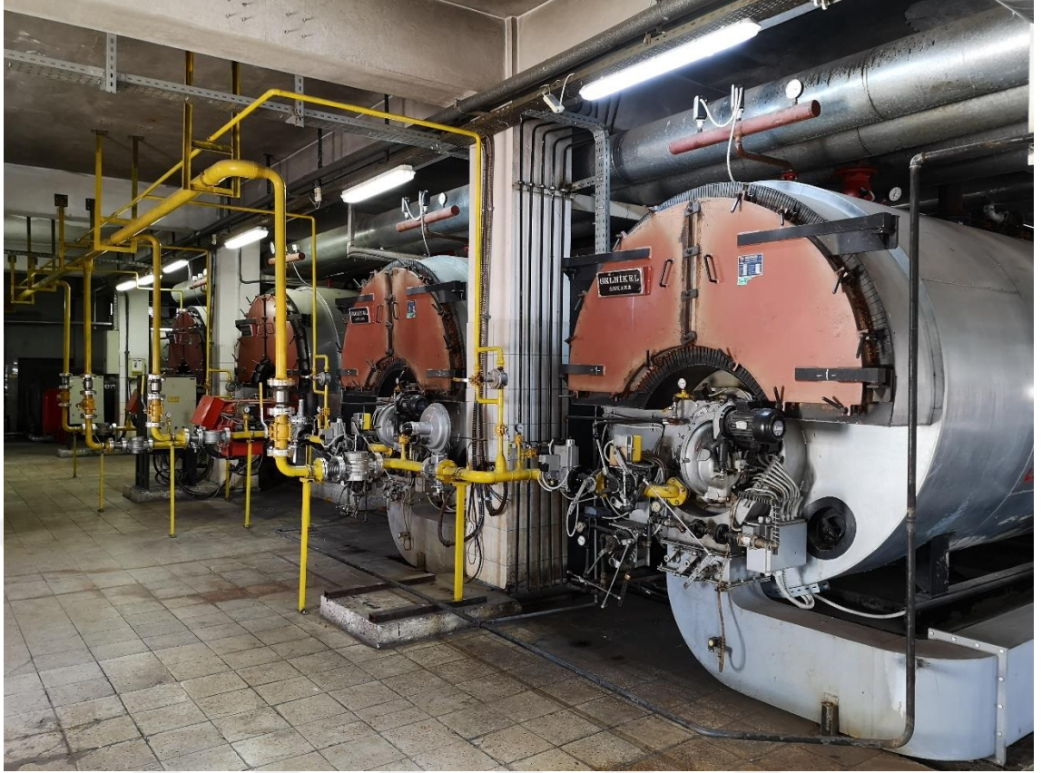
Şekil 3.2. Kafkas Üniversitesi Paşacıyırı Yerleşkesi Isı Merkezi
