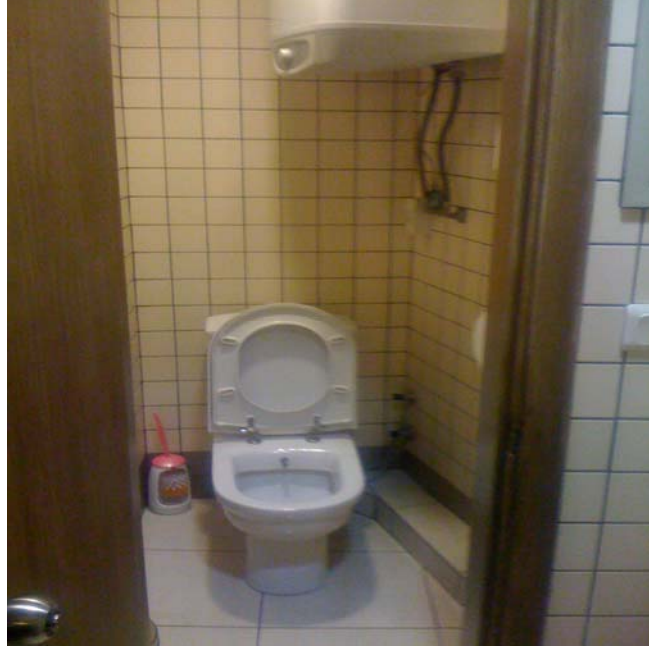
Şekil. 5.8. Restoranın Temizlik Açısından Mevcut Durumdaki Tuvaletinin Görüntüsü.
