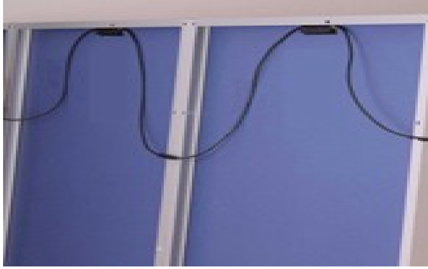
Şekil No 52: PV Panel Kablo Bağlantısı
