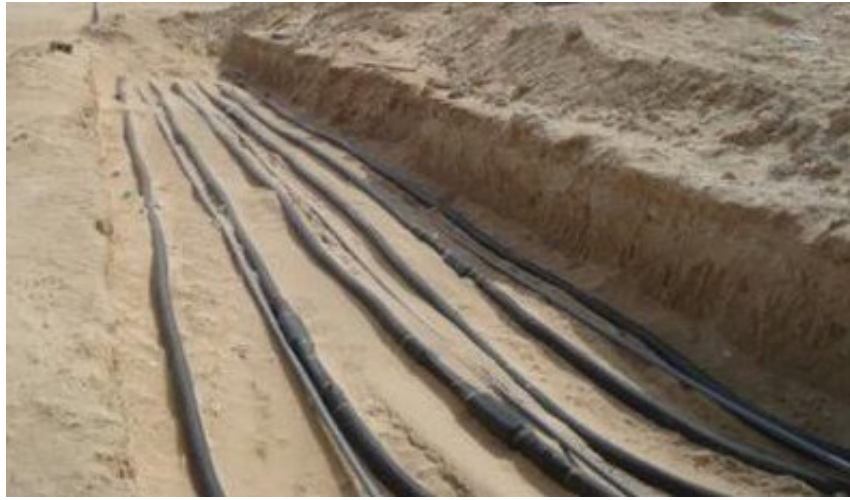
Şekil No 53: PV Panel Yeraltı Kablo Bağlantısı
