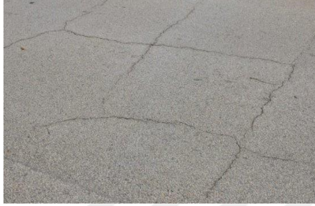
Şekil 3.13. Büzülme çatlağı görüntüsü
