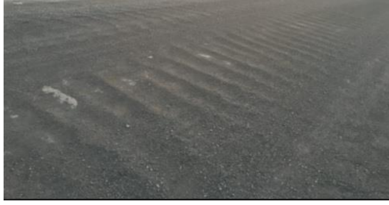
Şekil 3.10. Ondülasyon bozulması (The Constructor, 2019)
