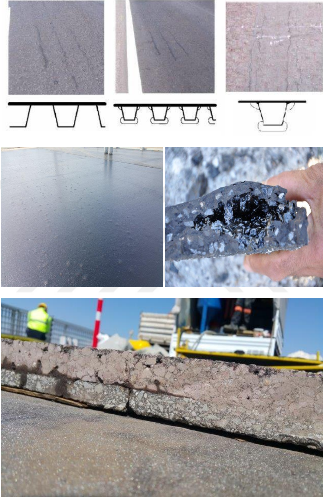
Şekil 3.18. Köprü kaplamalarında meydana gelen bozulma örnekleri
