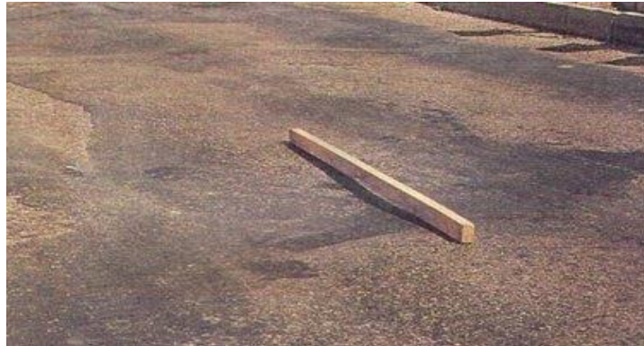
Şekil 3.11. Çökme bozulması ( İlçalı vd., 2001)
