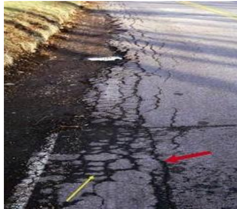
Şekil 3.14. Kenar çatlağı görüntüsü (Cornell, 2008)
