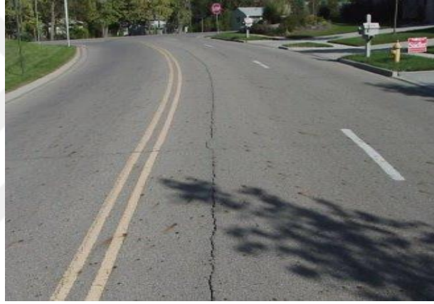
Şekil 3.15. Derz çatlağı görüntüsü
