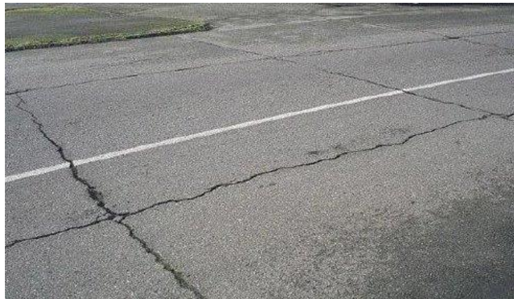
Şekil 3.17. Yansıma çatlağı görüntüsü
