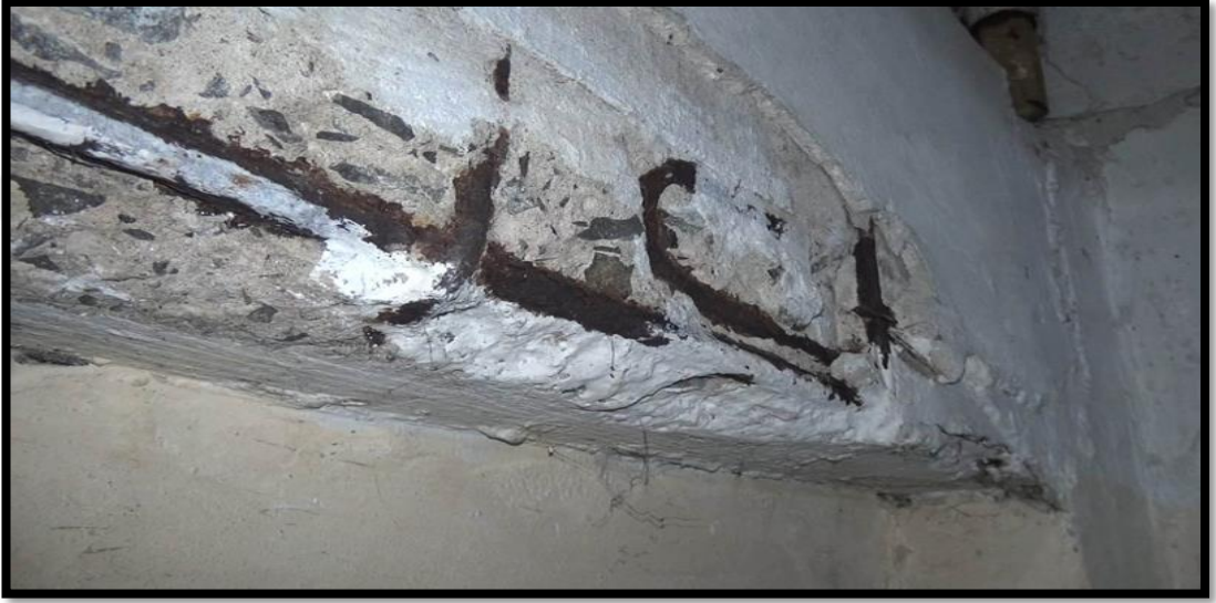
Şekil 3.8. Rize dolgu alanında bulunan binanın kolonlarında meydana gelen deformasyon (Kişisel Arşiv,2019).
