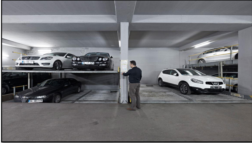
Şekil 3.7. Kuyulu bağımsız mekanik otopark çözümü Zühtü Tursan Apartmanı, Kadıköy İstanbul (Otomatik, 2019)
