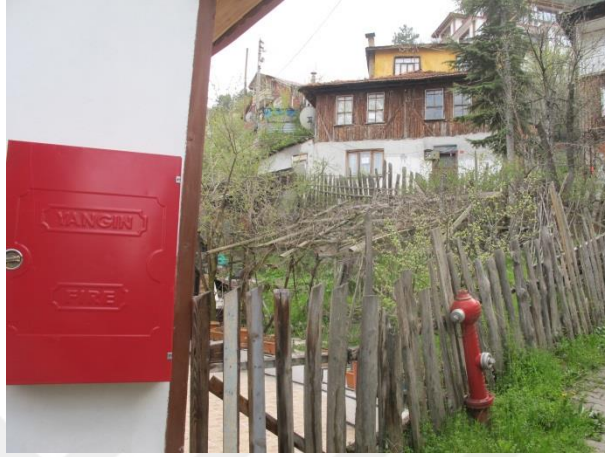
Şekil 3. 38: Çalışma alanı içerisindeki yangın söndürme vanası
