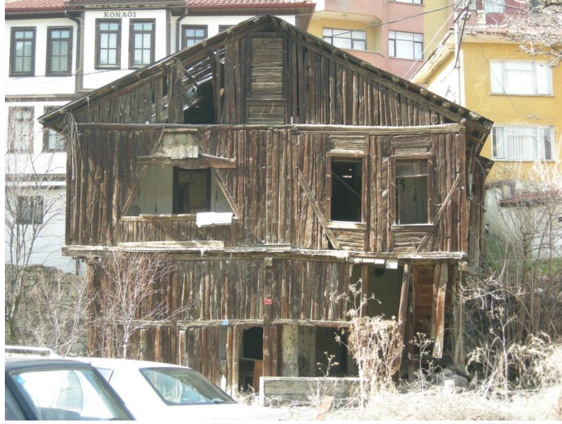
Şekil 3. 9: Harap durumdaki kullanılmayan geleneksel yapı
