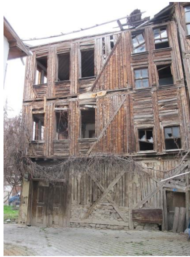
Şekil 3. 20: Strüktür ve malzemesi harap durumda olan geleneksel yapı
