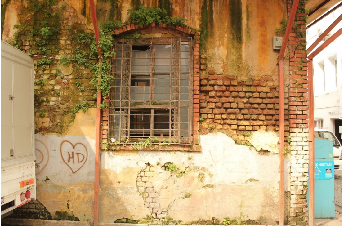
Şekil 5. 43: Dođu Cephede Sıva Kaybı Sonrası Bozulmalar Oluşmuş Duvar Yüzeyi (Erdim, 2019)
