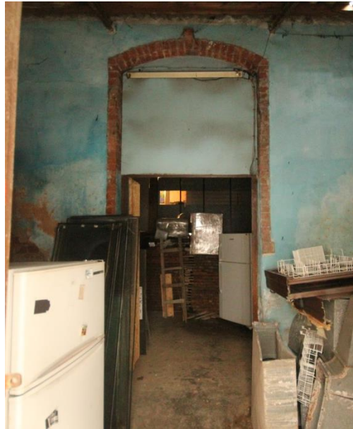
Şekil 5. 9: Z02 Numaralı Mekanın Batı Duvarında Yer Alan Muhdes Kapı Boşluğunun Cephe Tarafından Görünüşü (Erdim, 2019)
