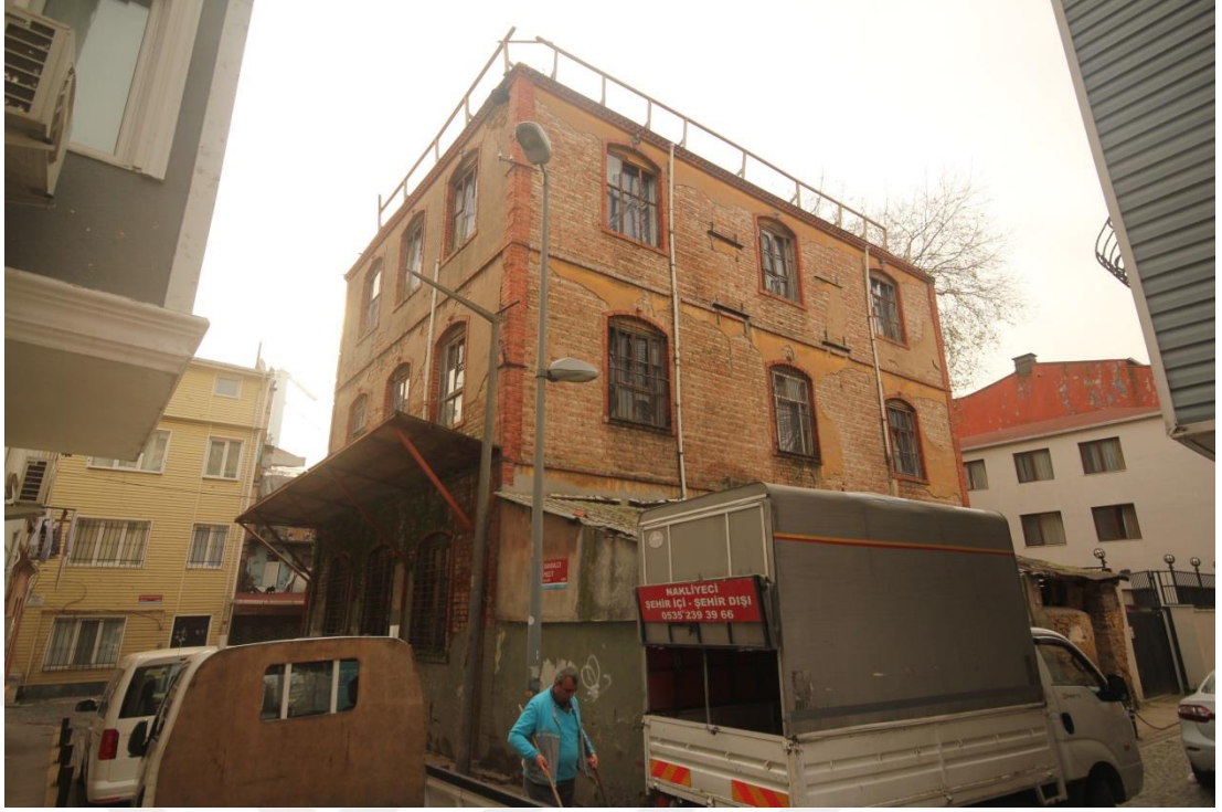
Şekil 5. 37: Dış Budak Sokak ve Sandalcı Mescit Sokak Kesişiminden Batı ve Kuzey Cephelerinin Görünüşü (Erdim, 2019)
