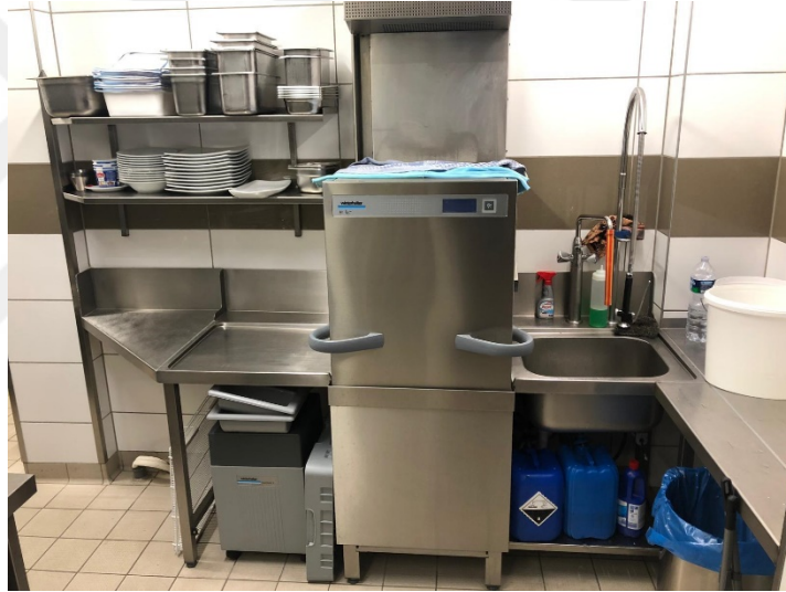
Şekil 135: Restoran mutfağı bulaşık alanı
