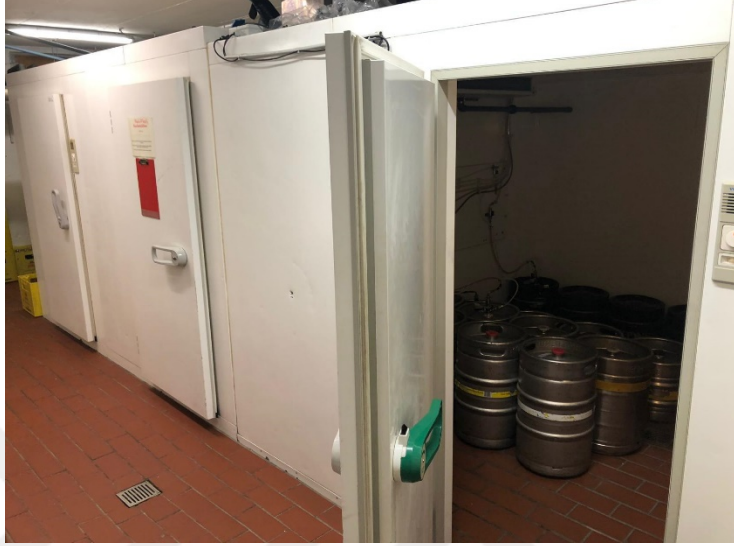
Şekil 126: Soğuk ve dondurucu depo girişleri
