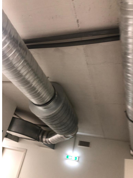
Şekil 111: Mekanik havalandırma kanalları
