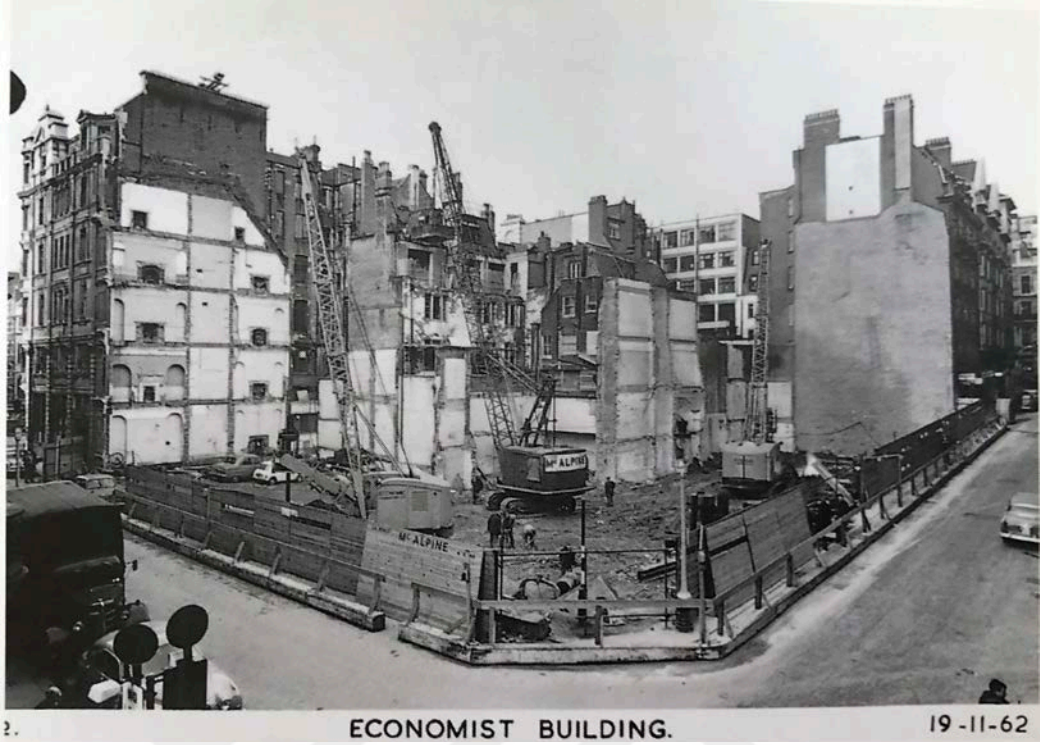
Şekil 4-6. “The Economist” binası inşaatı öncesi Ryder Caddesi ve Bury Caddesi görüntüsü Fotoğraf: John Maltby, 1962
