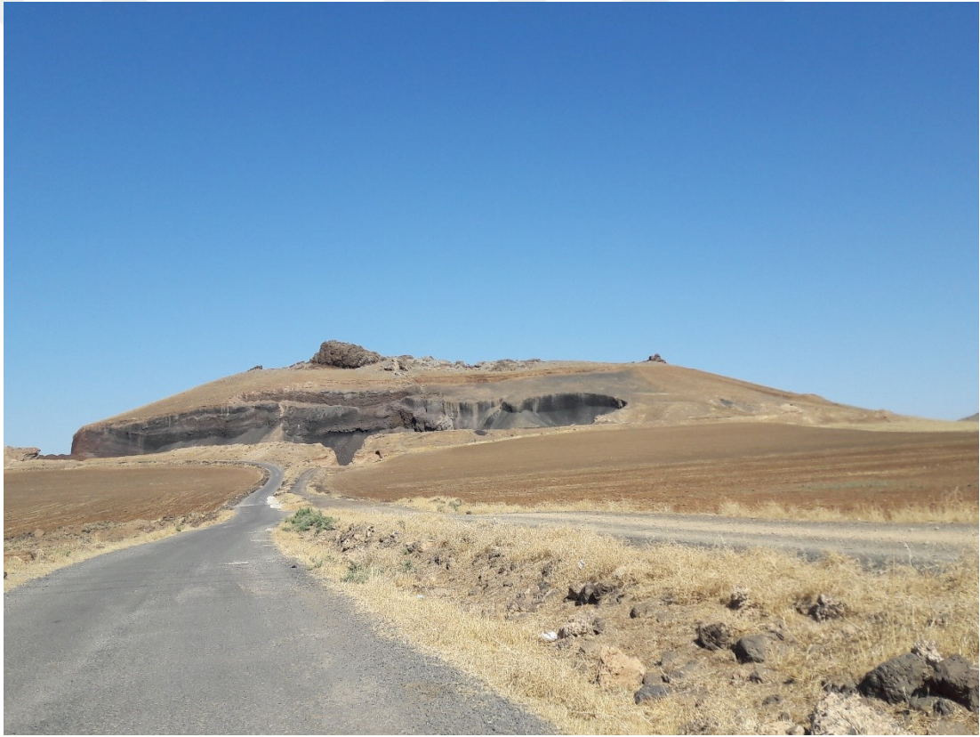
Fotoğraf 29: Derik İlçesinin Güneyinde Bulunan Kuşçu Konisinin Yamacında Malzeme Alımı İçin Yapılan Kazı Çalışmasının Doğudan Görünümü
