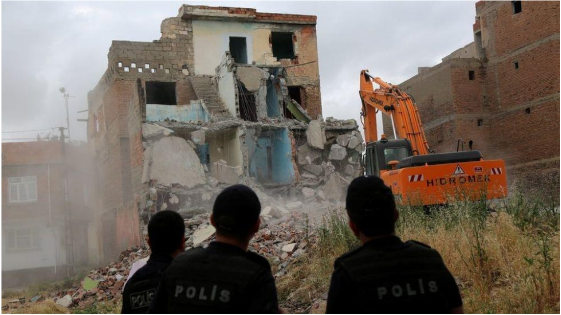
Fotoğraf 8 : Suriçi’nde Kentsel Dönüşüm Kapmasında Yıkılan Evler
