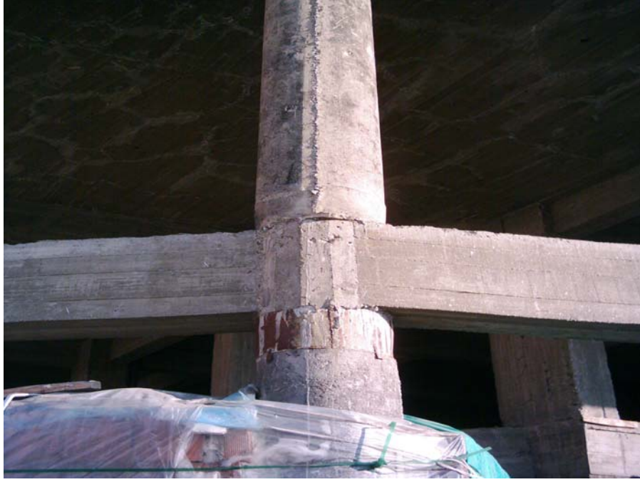
Şekil 4.15. Projesi ve hesaplamaları yapılan binanın zemin kattaki fretli kolon fotoğrafı
