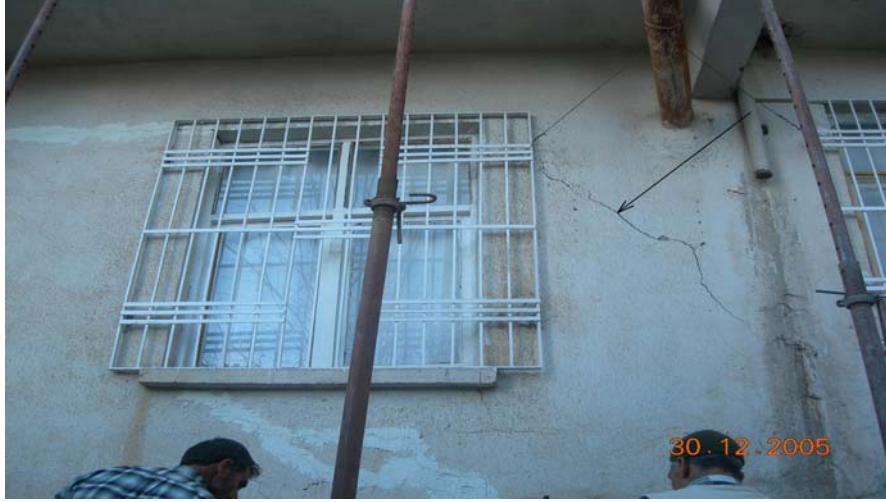
Şekil 4.1. Binadaki oturmanın etkisiyle oluşan çatlaklar
