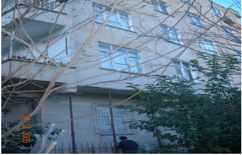
Şekil 4.5. Balkon döşemelerinin altındaki bina desteği
