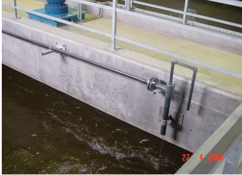
Şekil 2.4. Yumaklaştırma havuzu ve polielektrolit dozajı
