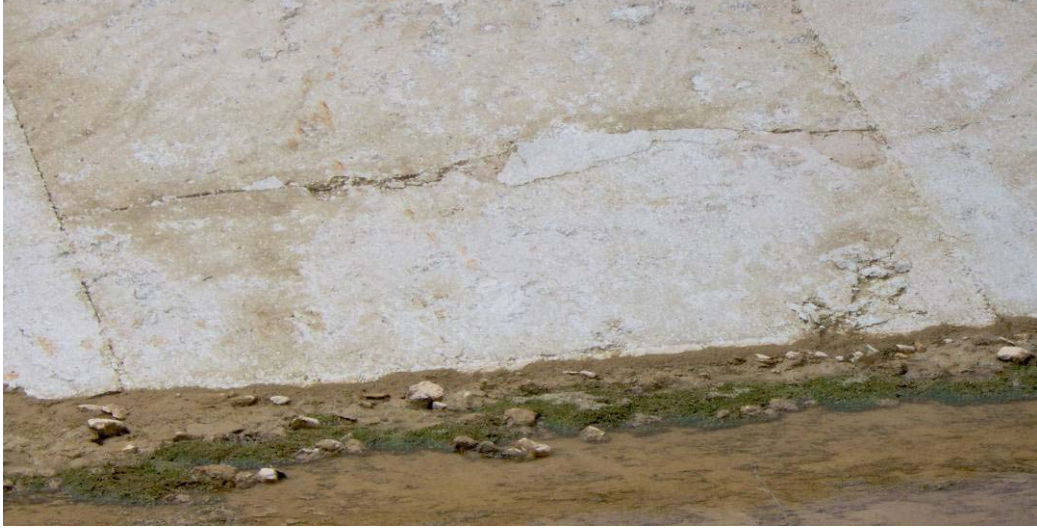
Şekil 4.2. Urfa ana kanalında ( UY4) çatlamış ve kısmen oturmuş beton kanalı
