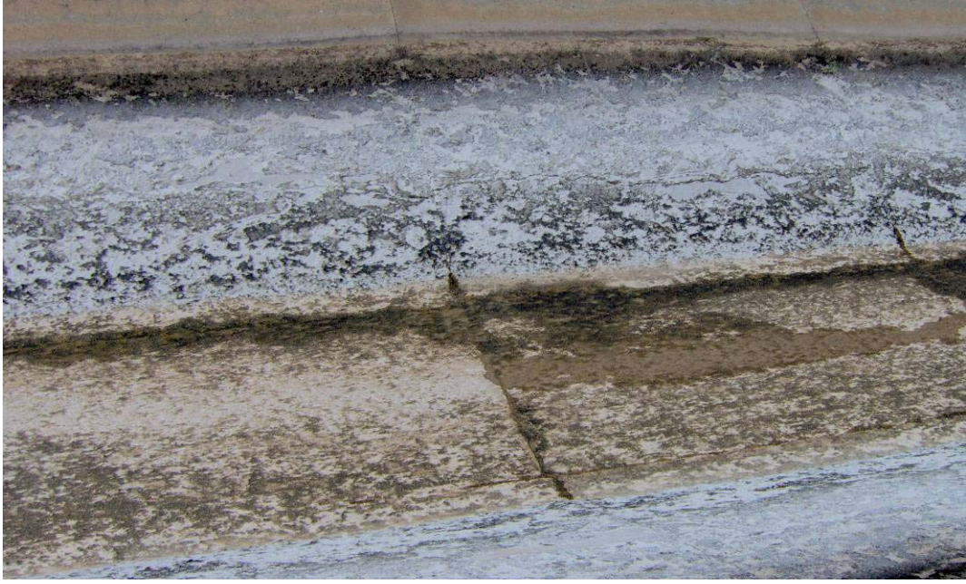
Şekil 4.6. Urfa ana kanalında yanmış ve çatlamış beton kaplaması
