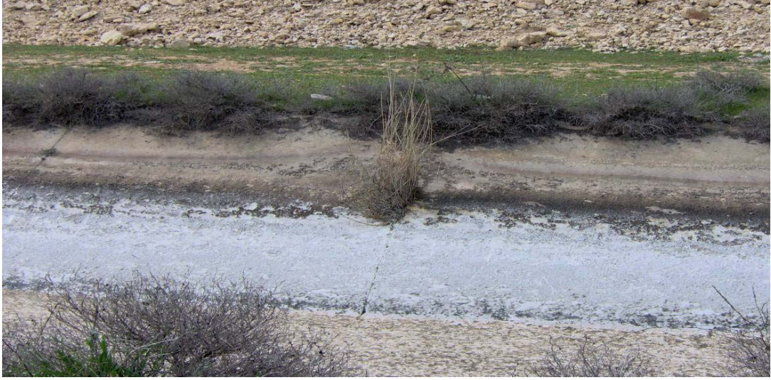
Şekil 4.4. Urfa ana kanalı şevi, derz aralığında oluşan bitkiler
