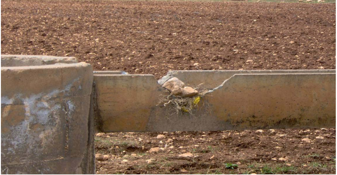
Şekil 4.9. Urfa sulamalarında kanaletlerin kırılarak su alınması
