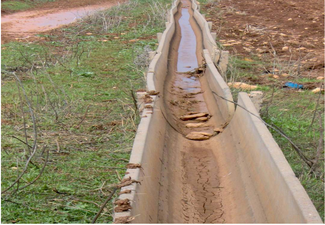
Şekil 4.11. Kanalet şebekelerinde oturmalara bağlı olarak bozulmalar
