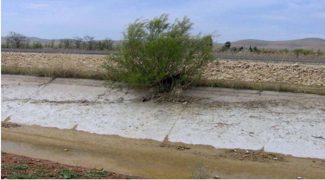
Şekil 4.3. Urfa ana kanalı beton kaplamasında oluşan bitkiler
