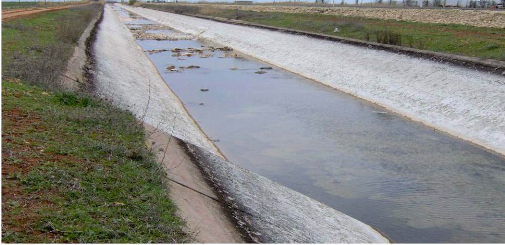
Şekil 4.14. Urfa ana sulama kanalı içerisinde taşlar
