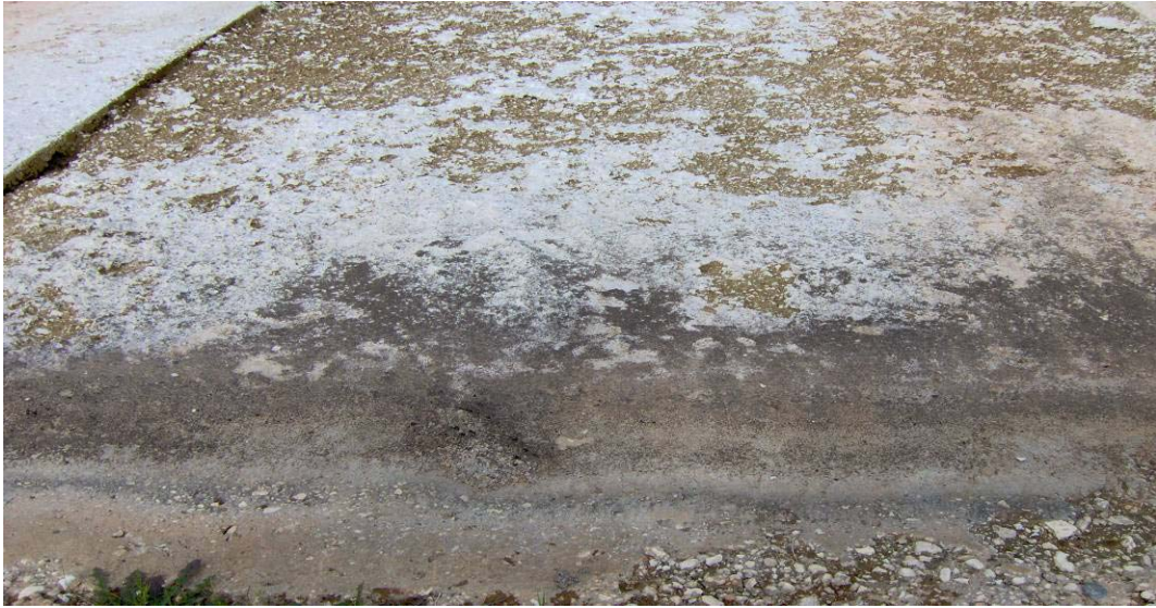
Şekil 4.5. Urfa ana kanalı; yanmış bir şev beton kaplaması
