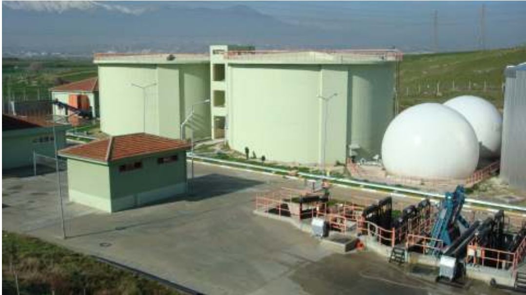
Şekil 1.17. Denizli Merkez Atıksu Arıtma Tesisine ait 2. kademe çamur çürütücüler
