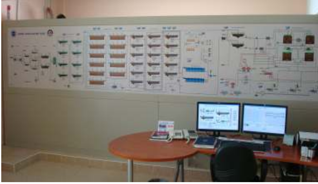
Şekil 1.18. Denizli Merkez Atıksu Arıtma Tesisine ait SCADA odası
