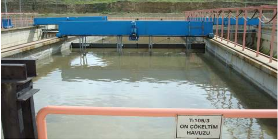
Şekil 1.14. Denizli Merkez Atıksu Arıtma Tesisine ait ön çökeltim havuzu
