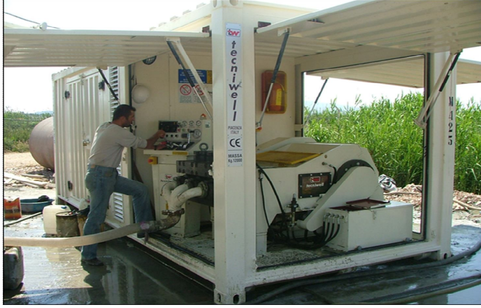
Şekil 3.16. Pompa ünitesi (Yıldız, 2011)
