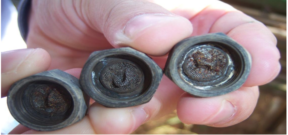
Şekil 4.3. Püskürtme memeleri içerisinde bulunan süzgeç problemlerinden birisi
