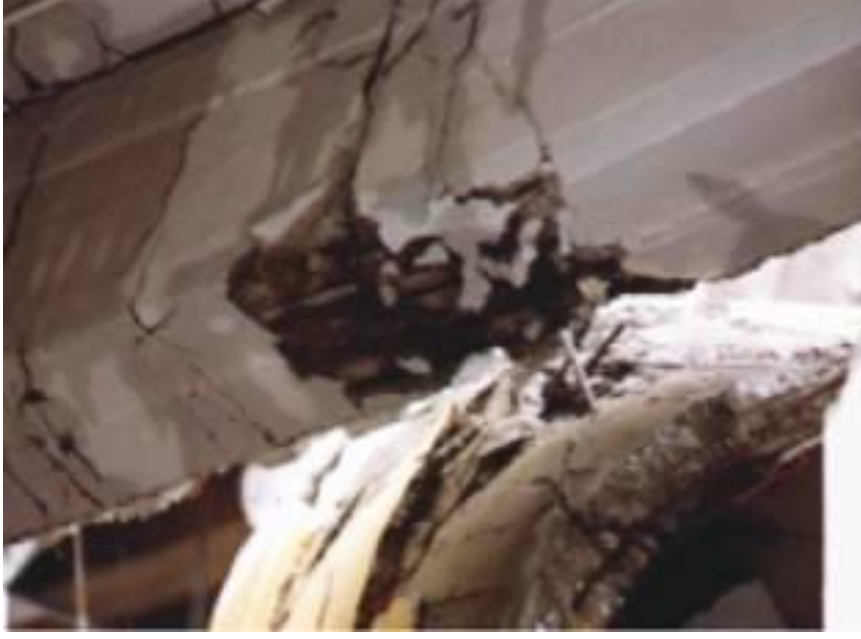
Şekil 3.8. Marmara depremi sonrasında oluşan bir kiriş hasarı
