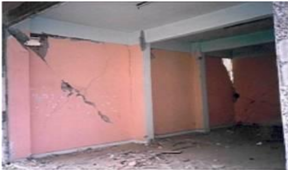
Şekil 3.6. Marmara depremi sonrasında gölcükte 6 katlı bir yapının zemin kat duvar çatlakları
