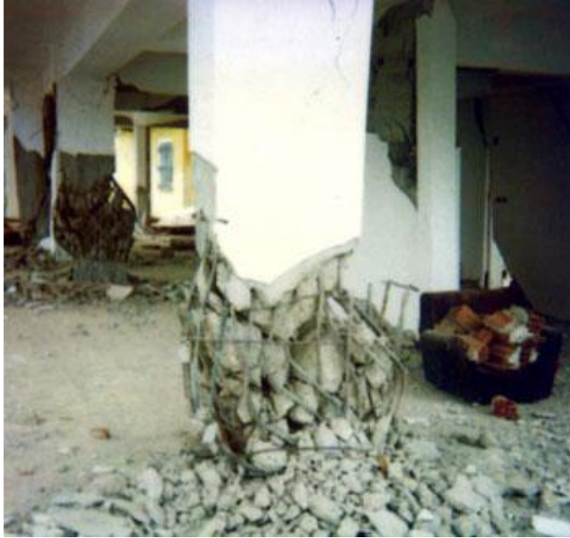
Şekil 3.10. Marmara depremi sonrasında Düzce' de yetersiz donatı ve kalitesi düşük beton kullanımı sonucu oluşmuş kolon hasarı
