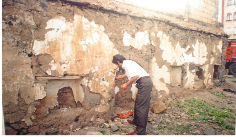
Şekil 6.1. Siverek İlçesinde yıkılmaya yüz tutmuş asbestli bir yapı (Barış, 2008).
