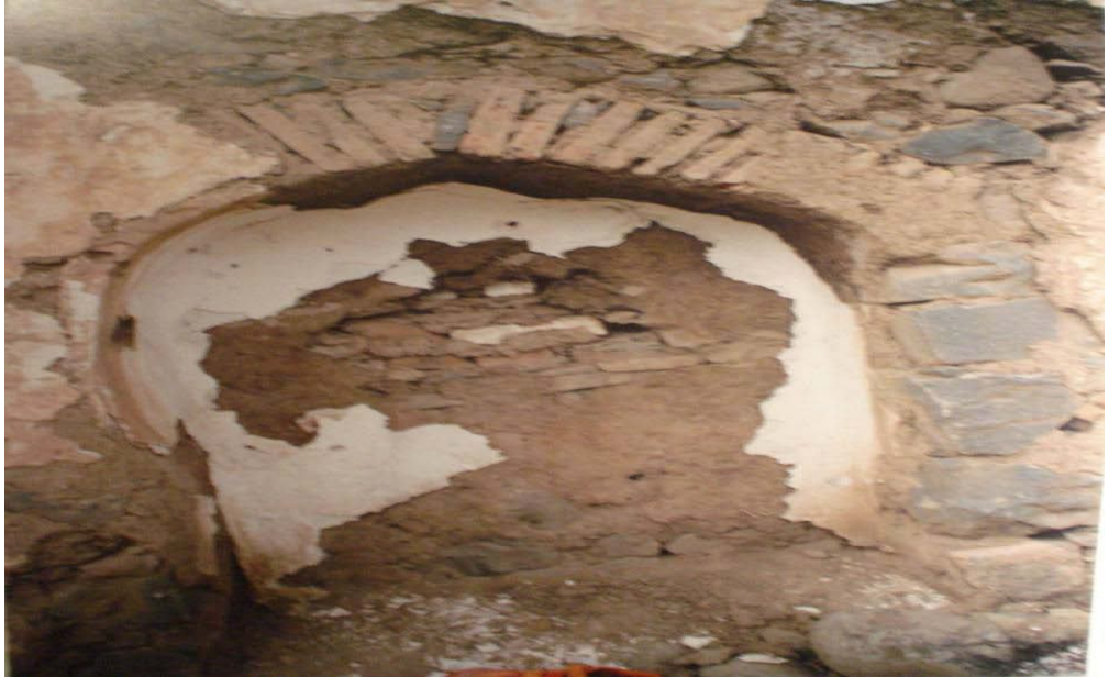
Şekil 4.6. Siverek'te sıva malzemesi olarak asbest kullanılmış bir yapı (Barış, 2008).
