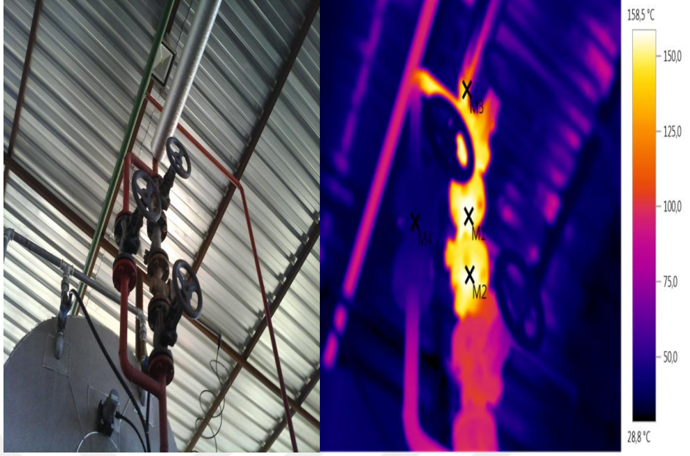
Şekil 4.15. Besi suyu tankının eşanjör bağlantı sisteminin termal görüntüsü
