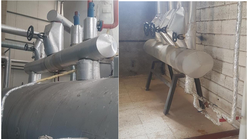
Şekil 4.24. Kollektör ve akümülatör üzerindeki buhar vanalarının yalıtım yapılmış görüntüsü
