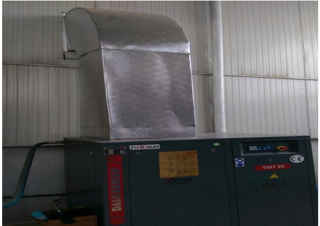
Şekil 4.8. Hava kompresörünün görüntüsü
