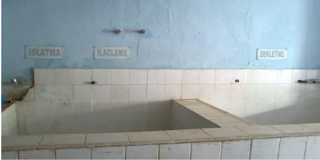
Şekil 3.3. Kompost ilaçlama bölümü
