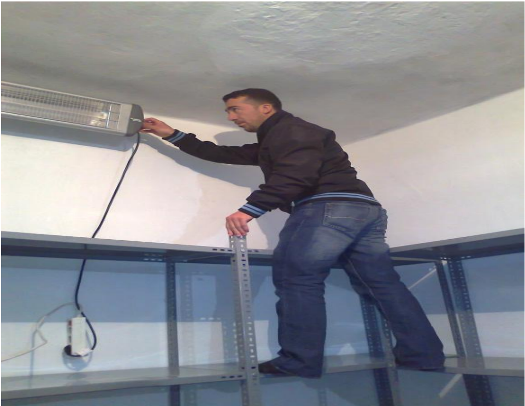
Şekil 3.2. Siirt Üniversitesi Eruh Meslek Yüksek Okulu mantar tesisi havalandırma ve ısıtma sistemi
