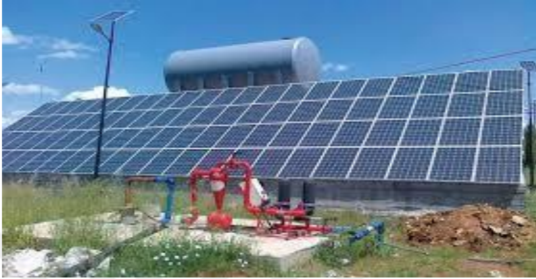
Şekil 4.9. Güneşin gözyaşları projesi kapsamında kurulan güneş enerjisi santrali (Behçet, 2013).
