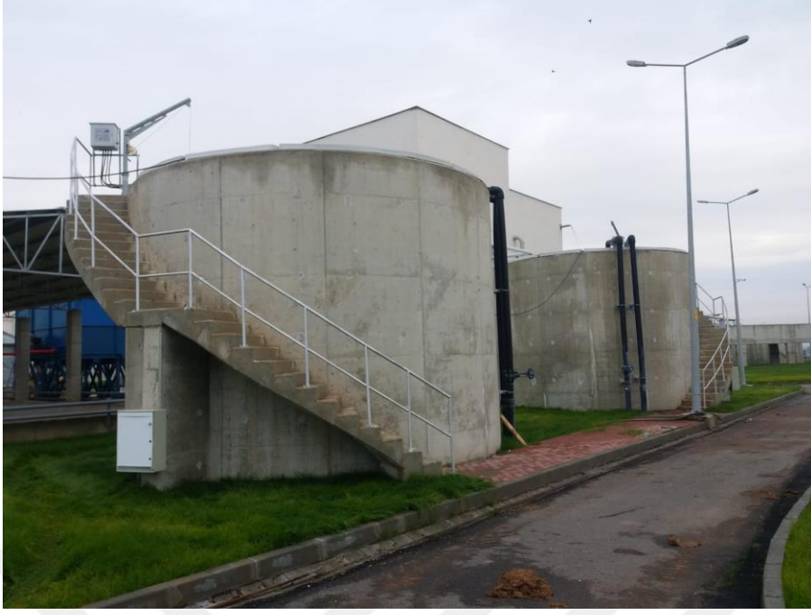
Şekil 3.6. Çamur depo tankları
