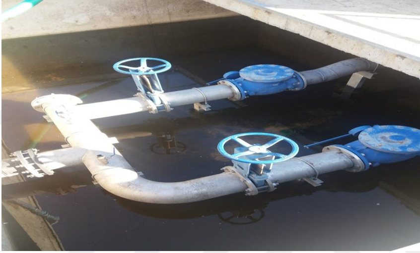
Şekil 3.3. Fazla çamur hattı
