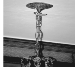
Uygun Olmayan Kablo
