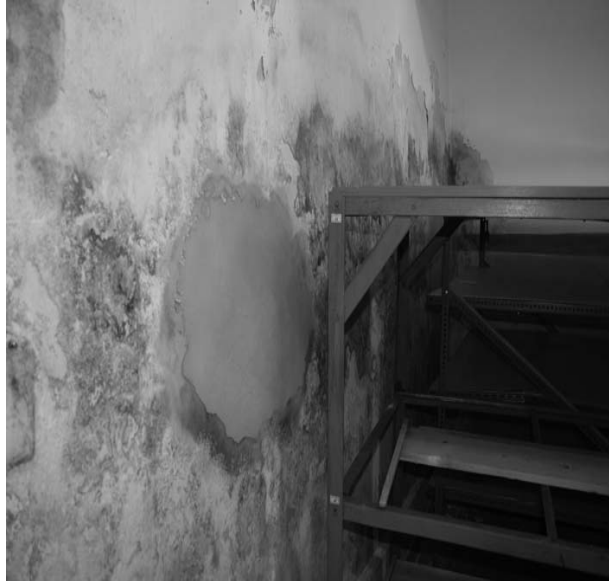
Şekil.8.36.; Depo Duvarında Görülen Rutubet
