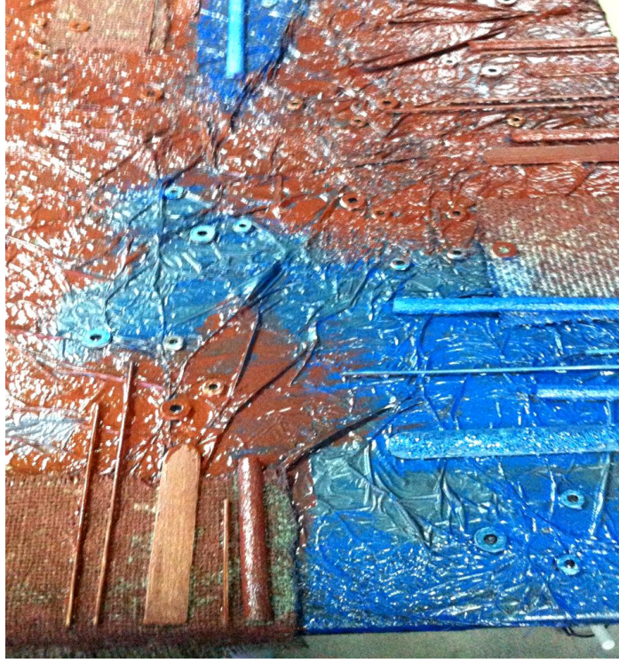
Şekil 8.320:Fonun renklenmesi (Çırpıcı,A., 2015, İst)
