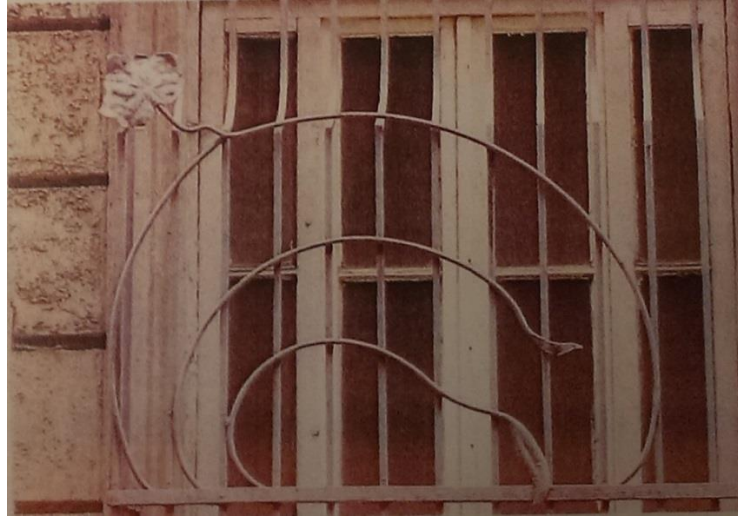
Şekil 5.1. Rasan Apartmanı, pencere demirleri (ayrıntı)
