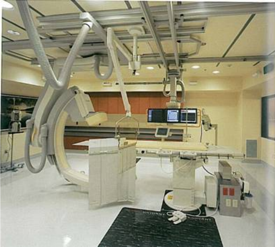
Fotoğraf 4.73: Peacehealth St. Joseph Hastanesi Görüntüleme Odasından Bir Görünüm (Regor Yee, Healthcare Spaces No:3, (VRP) Visual Reference Publications, Inc., New York, s.248.)
