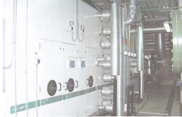
Resim-42. HVAC Sistemin ve Kumanda Panosunun Bodrumda Bulunma Durumu.
