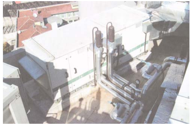
Resim-43. HVAC Sistemin ve Kumanda Panosunun Çatıda Bulunma Durumu.
