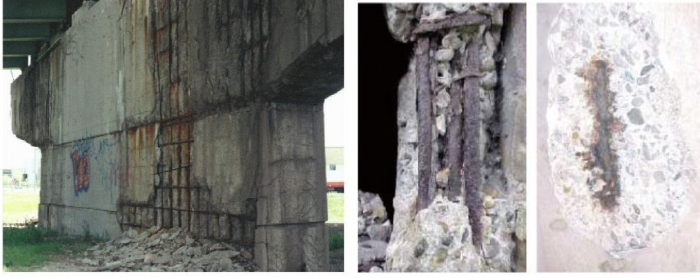
“Şekil 2.8” Korozyonun Zararlı Etkileri
