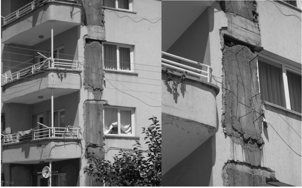
Şekil 1.33. Yanlış güçlendirme yapılan kolonlar ve binanın genel görünüşü
