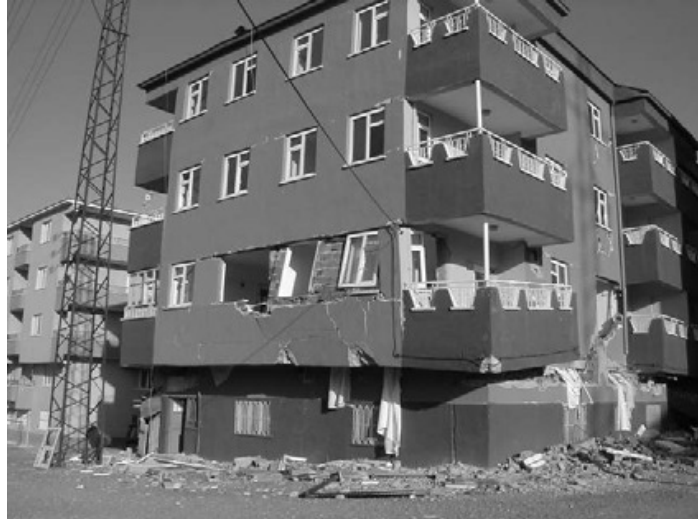
Şekil 1.31. Ağır hasarı gözle tespit edilen bina
