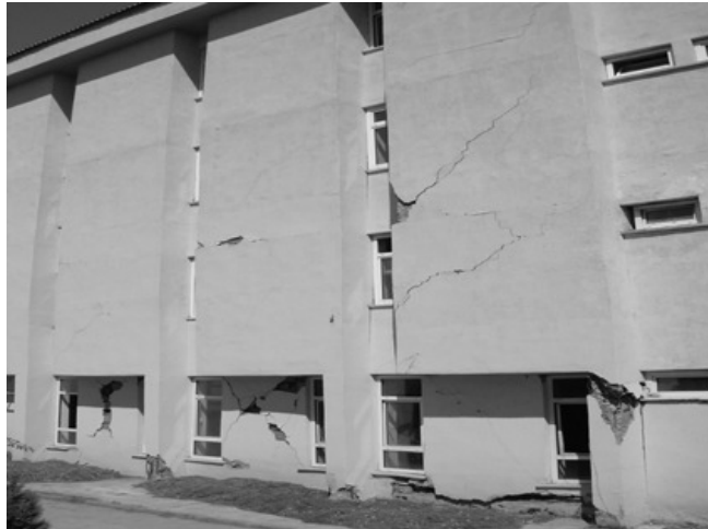
Şekil 1.32. Ağır hasarı gözle tespit edilemeyen bina
