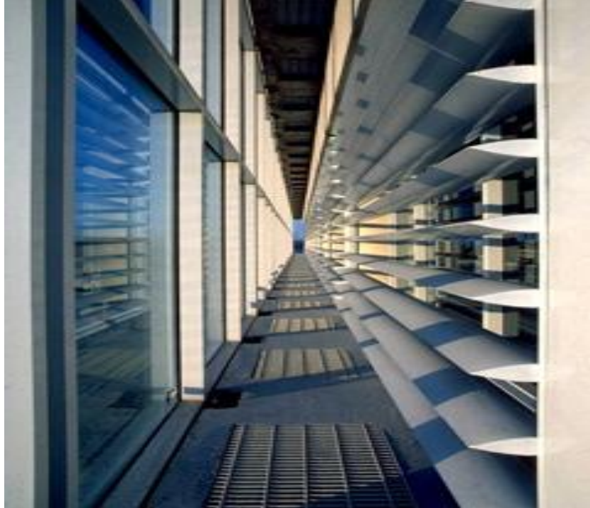
Resim 4.32. Bina Yüksekliğinde Havalandırma Kanallı Çift Tabakalı Sistem İçten Görünüş (Occidental Chemical Centre Binası)
