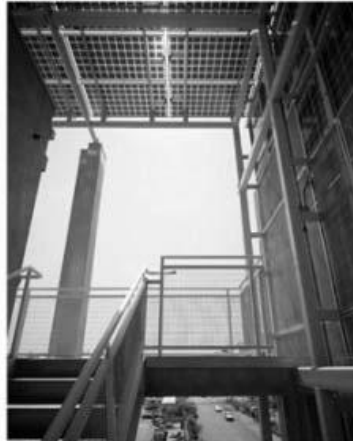
Resim 6.2:Colorado Court yapısının merdiven kısmındaki duvar tipi güneş panelleri
