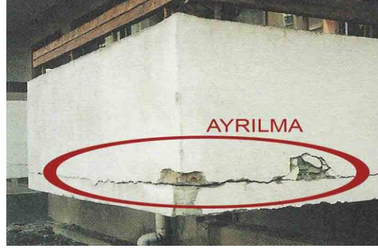
Resim 3.2. Balkon Parapetindeki Tuğla ve Betonarmenin Genleşme Katsayılarındaki Farklılık Nedeniyle Birleşim Yerlerinden Ayrılması 59
