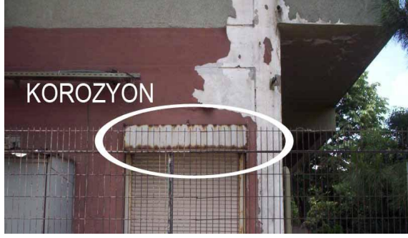
Resim 3.20. Saçakta Gözlenen Korozyon Sorunu
