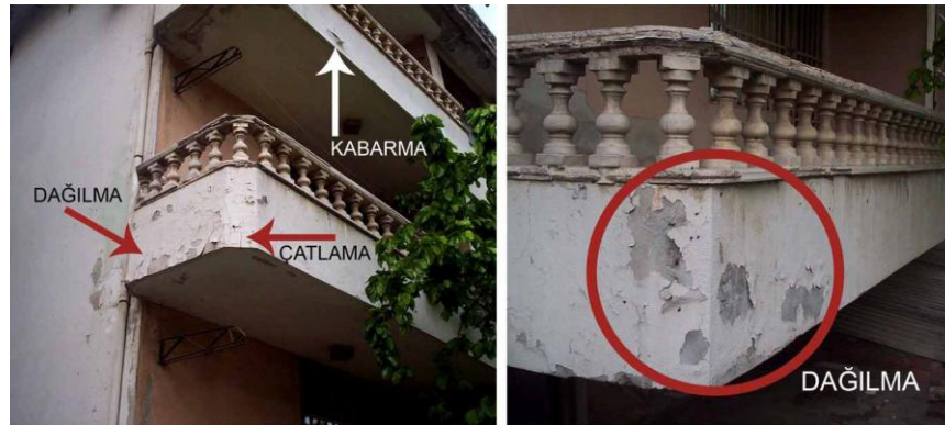
Resim 3.16. Yapı Cephesinde Kabarma, Çatlama ve Dağılma Sorunları
