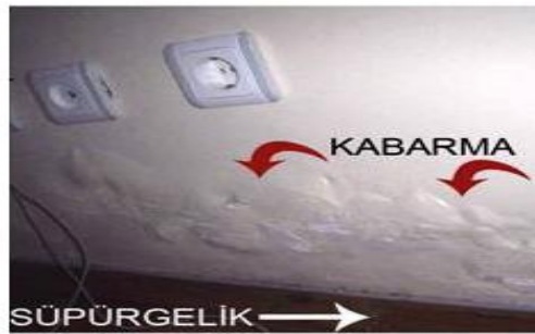
Resim 3.14. İç duvarda Kabarma Sorunu
