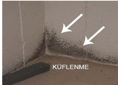
Resim 3.17. Duvarlarda Gözlenen Küflenme Sorunu
