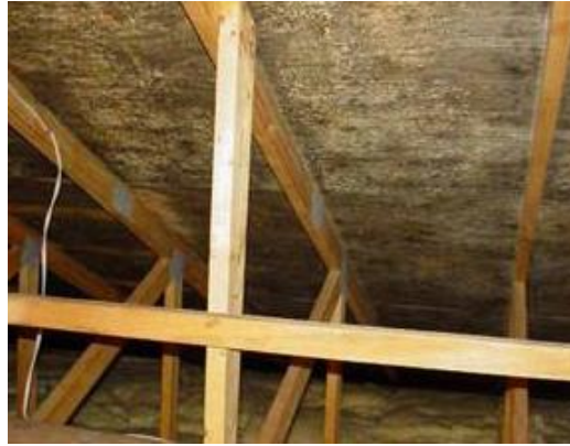
Resim 3.18. Havalandırılmayan bir çatı arasında oluşan küf ve mantar sorunu
