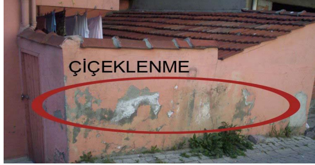
Resim 3.11. Yapı Cephesinde Çiçeklenme Gözlenmesi
