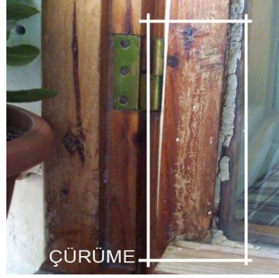
Resim 3.22. Ahşap Doğramada Çürüme Sorunu
