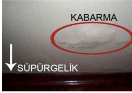
Resim 3.13. Dış Duvarda Kabarma sorunu
