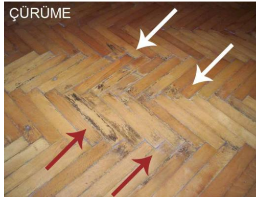
Resim 3.23. Ahşap Döşemede Çürüme Sorunu
