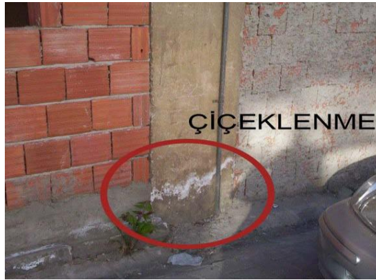
Resim 3.12. Subasman Seviyesinde Çiçeklenme Gözlenmesi
