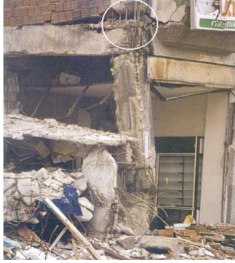
Resim 3.25. Donatıların Paslanarak Kesitlerinin Zayıflaması ve Zamanla Çürümeyle Yapıda Ağır Hasarların Oluşması
