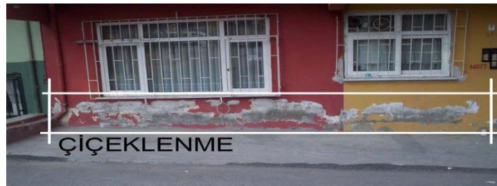
Resim 3.10. Subasman Seviyesinde Çiçeklenme Gözlenmesi
