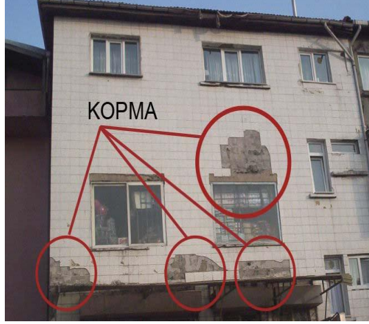
Resim 3.5. Dış Cephede Basınç Oluşması ve Yüzeyde Kopma Gözlenmesi
