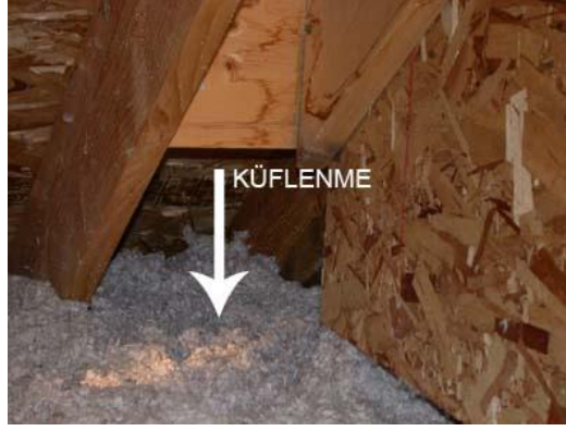
Resim 3.19. Havalandırılmayan Çatı Arasında Küflenme Sorunu
