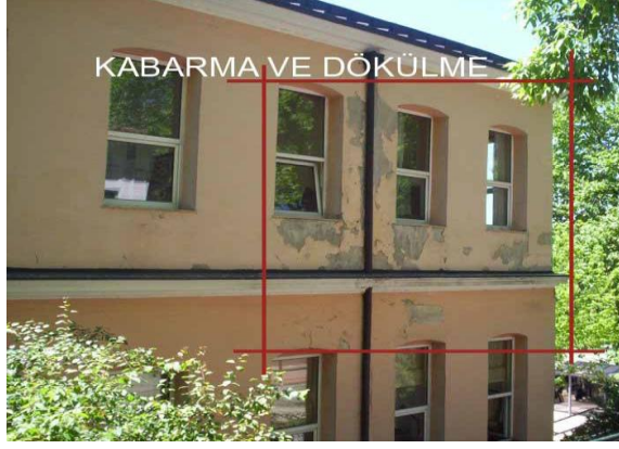
Resim 3.8. Dış Cephe Boyasının Kabarması ve Dökülmesi
