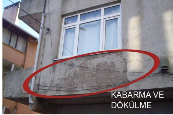
Resim 3.7. İnce Sıvanın Kabarması ve Dökülmesi
