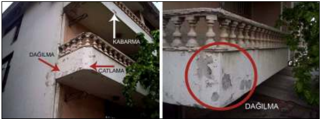
Resim 3.15 Yapı cephesinde kabarma, çatlama ve dağılma sorunlarının gözlenmesi 68
