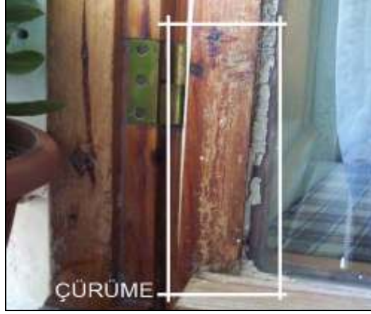
Resim 3.22 Bir konutun ahşap doğramasındaki çürüme sorunu 74
