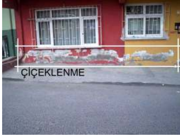
Resim 3.11 Subasman seviyesinde çiçeklenme gözlenmesi 66
