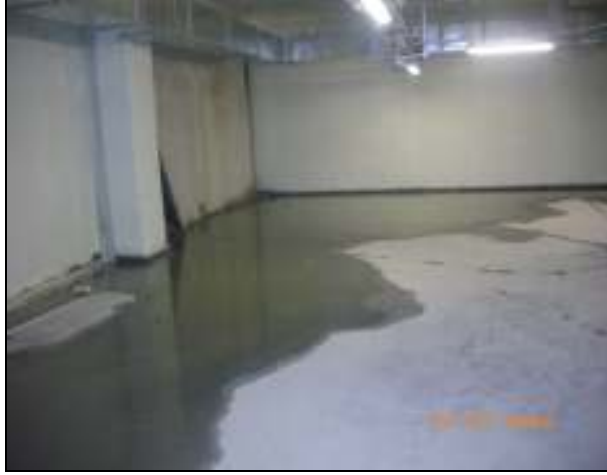
Resim 3.36 Zemine oturan bodrum kat döşemesinden basınçlı suların içeri sızması
