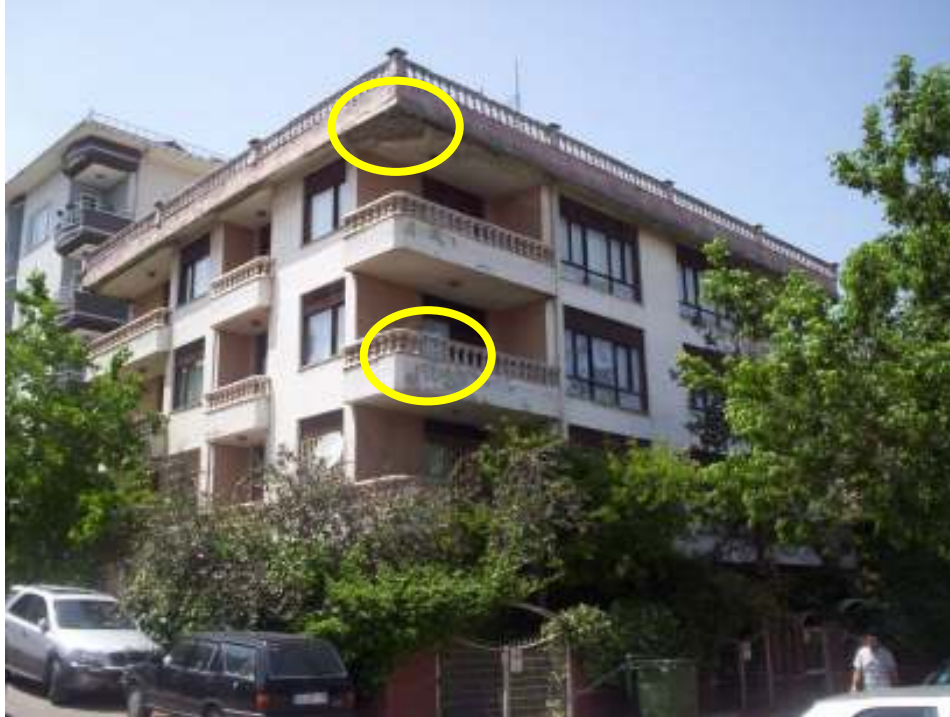
Resim 3.31 Su ve ısı etkenlerinin oluşturduğu sorunlar ile bakımsız bir betonarme yapı 83
