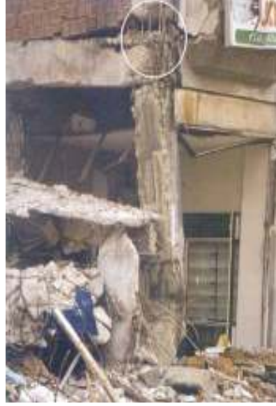
Resim 3.28 Kocaeli Depremi'nde donatıların paslanması ile yapıda oluşan ağır hasar
