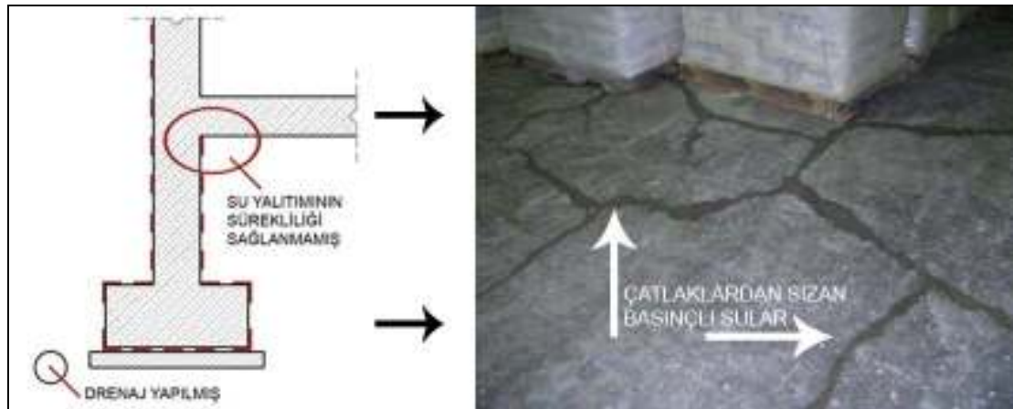
Resim 3.37 Zemine oturan bodrum kat döşemedeki çatlaklardan sızan basınçlı sular
