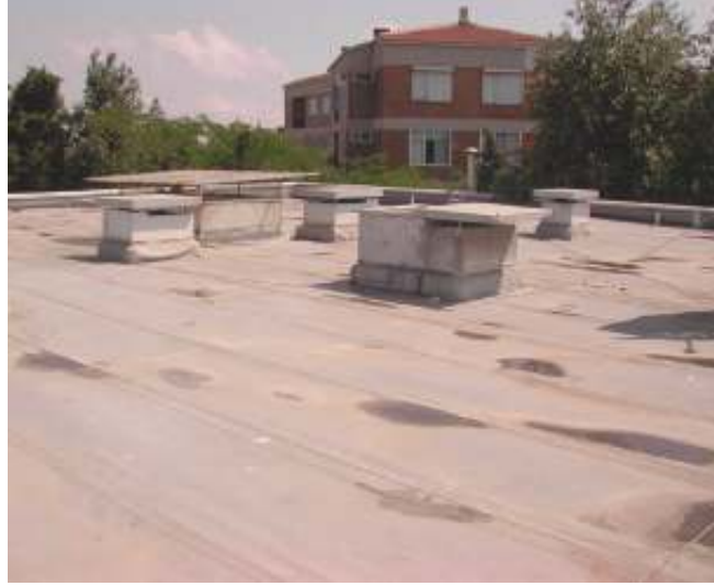
Resim 3.45 Çatının kullanım aşamasında çatıda oluşan su sorunu 101
