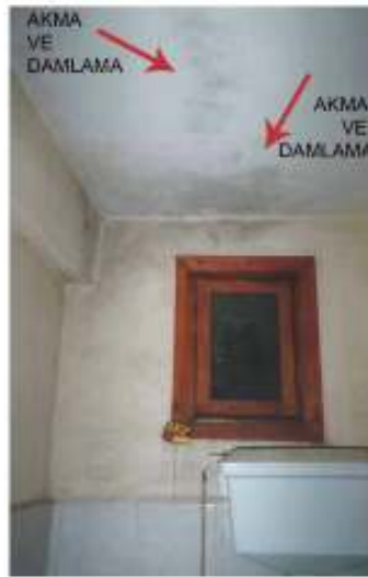
Resim 3.25 Bir konutun ıslak hacim tavanında gözlenen akma ve damlama sorunu 75
