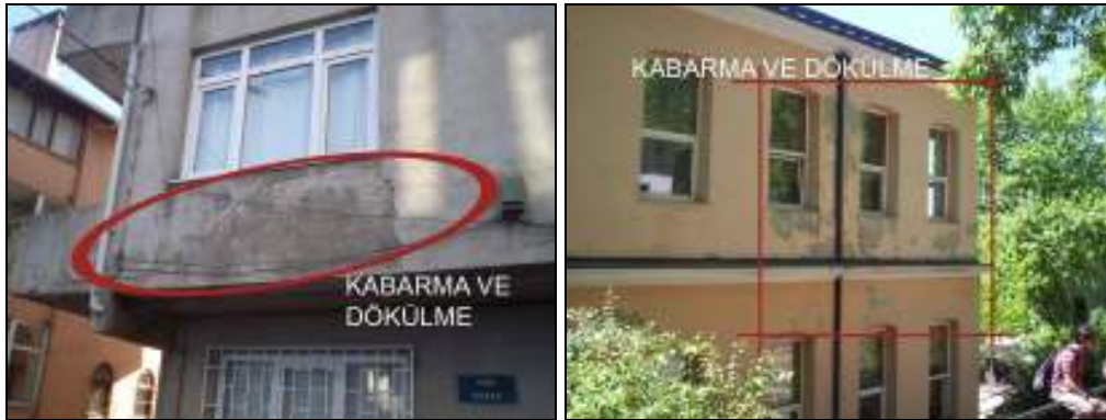
Resim 3.8 Yapının dış cephesinde gözlenen şişme ve büzülme, ince sıva ve dış cephe boyasının kabarması ve dökülmesi 64
