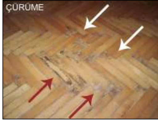
Resim 3.24 Su ve ısı etkenlerinin ahşap döşeme kaplamasında oluşturduğu çürüme
