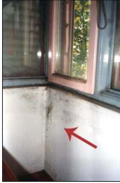
Resim 3.34 Tasarım aşamasında yalıtım uygulamalarına yönelik çözümlerin hatalı oluşturulması nedeniyle oluşan sorunlar 95
