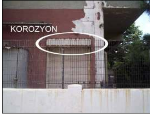
Resim 3.20 Bir servis girişinin saçağında gözlenen korozyon sorunu 71
