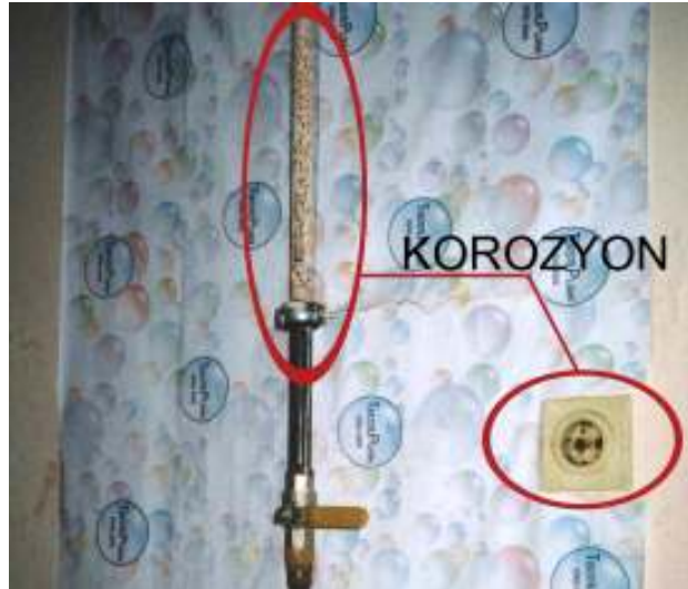
Resim 3.19 Mutfak hacmindeki metal borularda ve elektrik prizinde gözlenen korozyon 72
