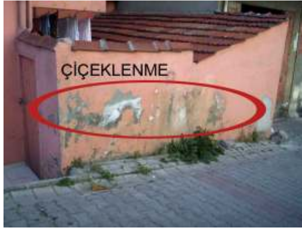
Resim 3.12 Yapı cephesinde çiçeklenme gözlenmesi 67
