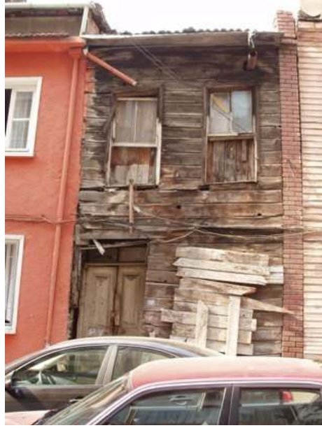
Resim 3.32 Su ve ısı etkenlerinin oluşturduğu sorunlar nedeniyle bakımsız bir ahşap yapı
