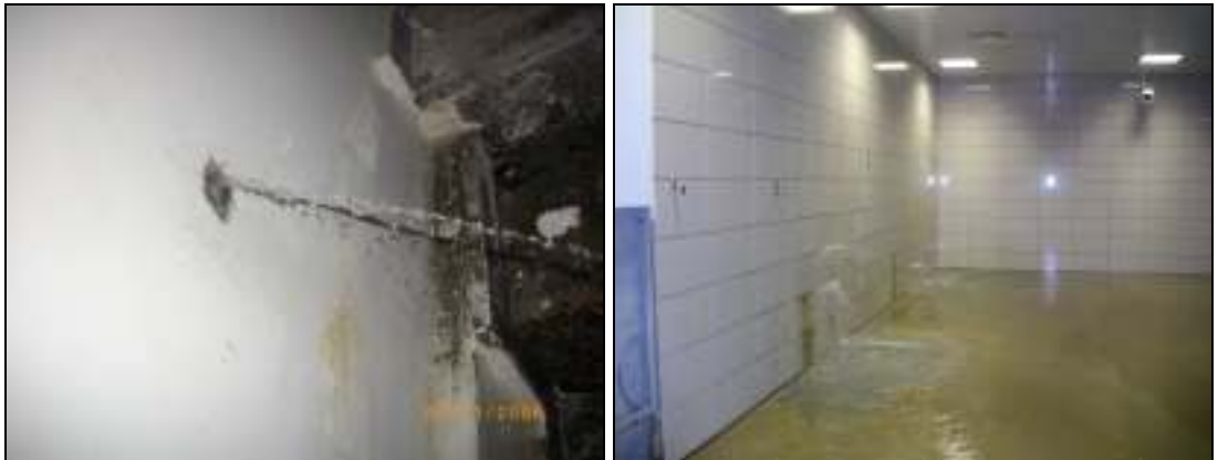
Resim 5.8 Yeraltı su seviyesi altında inşa edilmiş metro istasyonunda su sorunu
