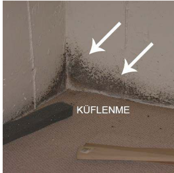
Resim 3.16 Duvarda gözlenen küflenme sorunu
