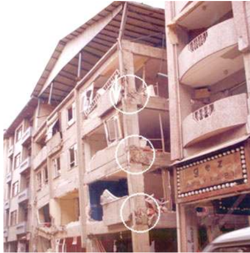
Resim 3.30 Kocaeli Depremi'nde içinden pvc yağmur iniř borularının geçtiđi kolonlarda donatıların paslanarak kesitlerinin zayıflaması ve zamanla çürümesi sonucu yapıda ağır hasarların oluşması 82
