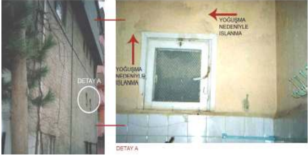
Resim 3.44 Cephedeki bakım eksikliği nedeniyle ortaya çıkan ısı farklılıkları sonucunda dış duvar kesitinde yoğuşma gözlenmesi
