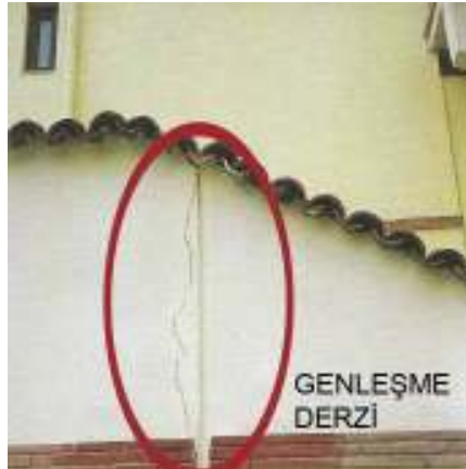
Resim 3.7 Harçla doldurulmuş genleşme derzi nedeniyle gerilmeleri karşılayamayan duvarda çatlak oluşumu 63
