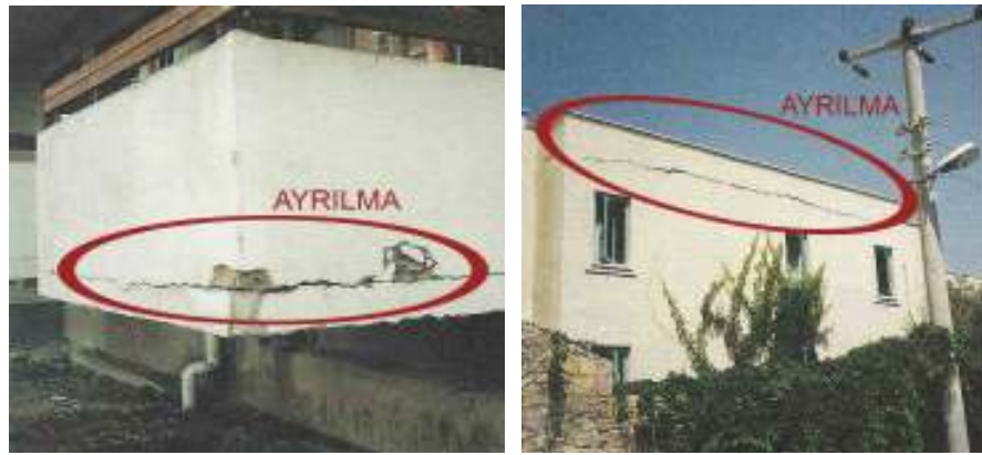
Resim 3.4 Balkon ve Çatı parapetindeki tuğla ve betonarmenin genleşme katsayılarındaki farklılık nedeniyle birleşim yerlerinden ayrılması 61
