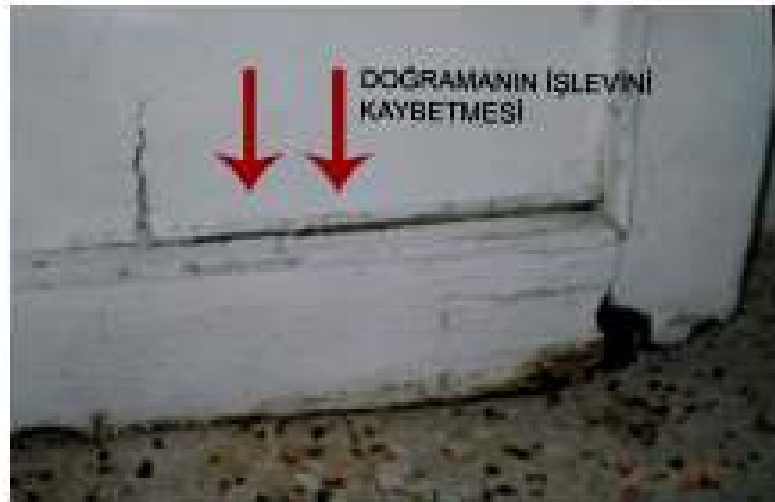
Resim 3.10 Su etkisiyle şişerek çatlamış ve koparak işlevini kaybetmiş ahşap bir ıslak hacim kapısı 65
