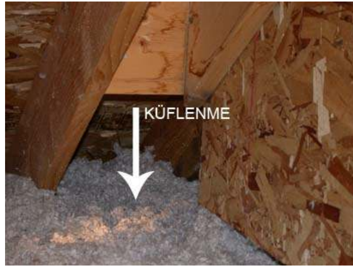
Resim 3.18 Havalandırılmayan çatı arası ısı yalıtım ürününde küflenme sorunu
