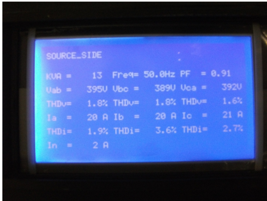
Şekil 7.8. Harmonik ölçüm sonuçlarının AHF cihazının ön panelinde gösterilmesi.
