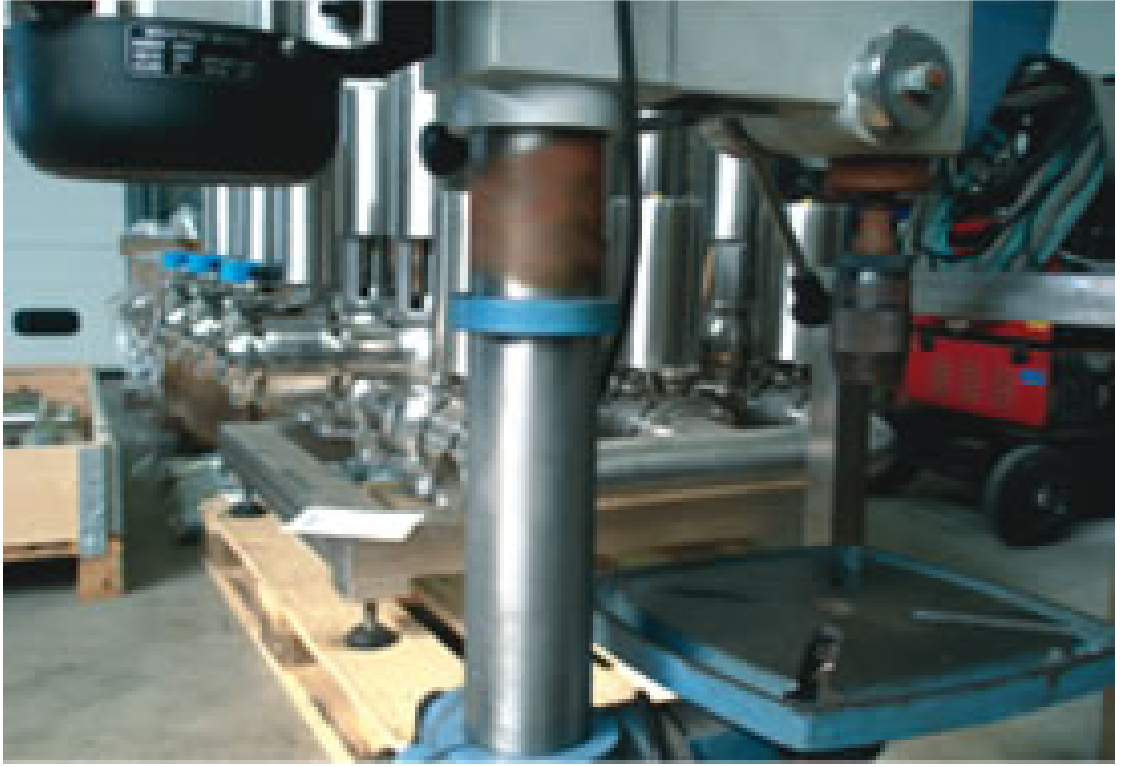
Şekil 4.5: Bakımsızlık nedeniyle korozyona uğramakta olan paslanmaz çelik ( www.demircelik.com.tr )
