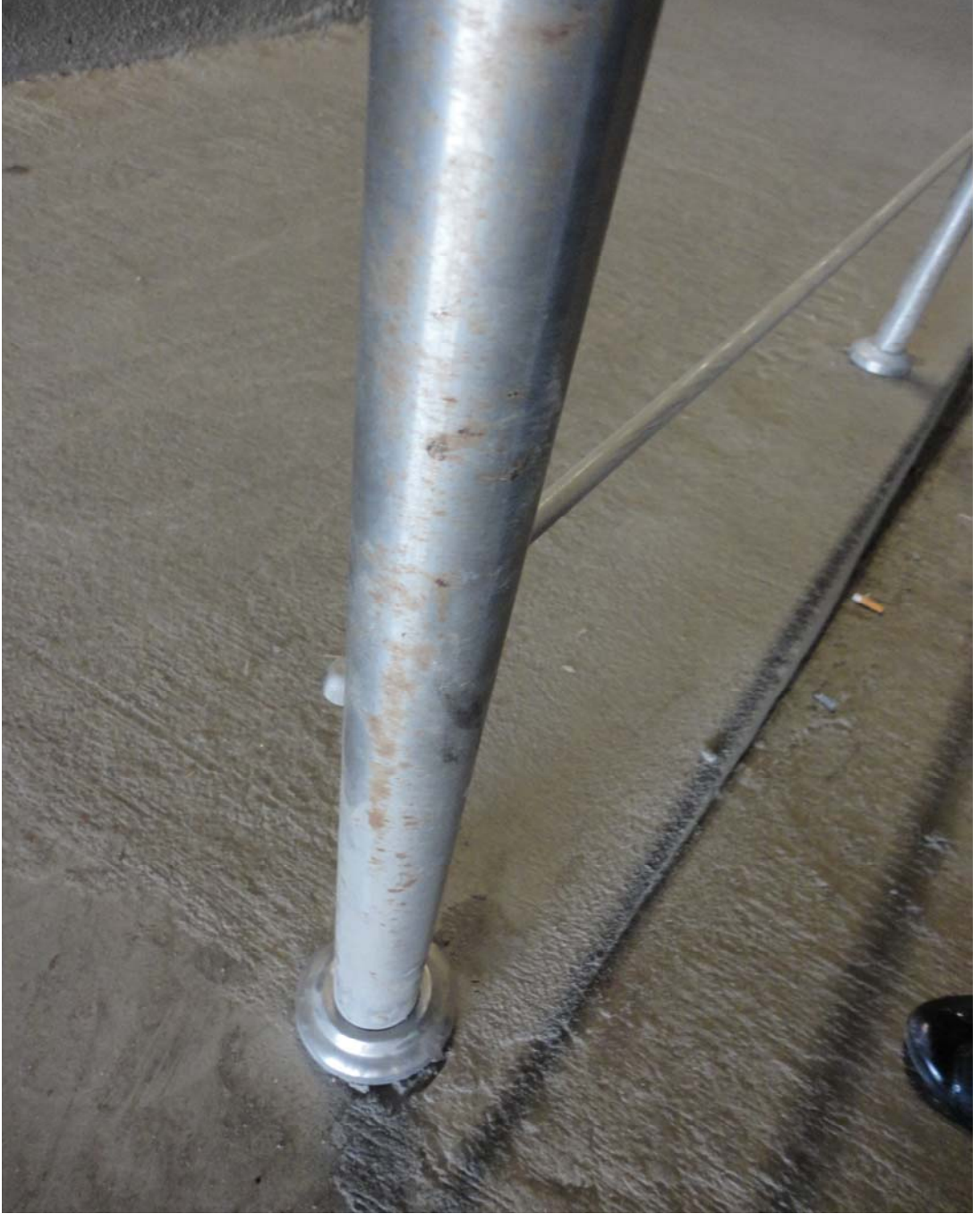
ekil 5.16: Bakımsızlık nedeniyle pasivasyon tabakası hasar grm dikme (Gkhan Mermi Arivi)
