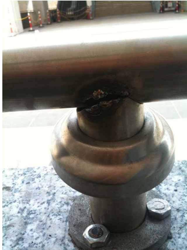
Şekil 5.9: Hatalı kaynak uygulaması (Gökhan Mermi Arşivi)
