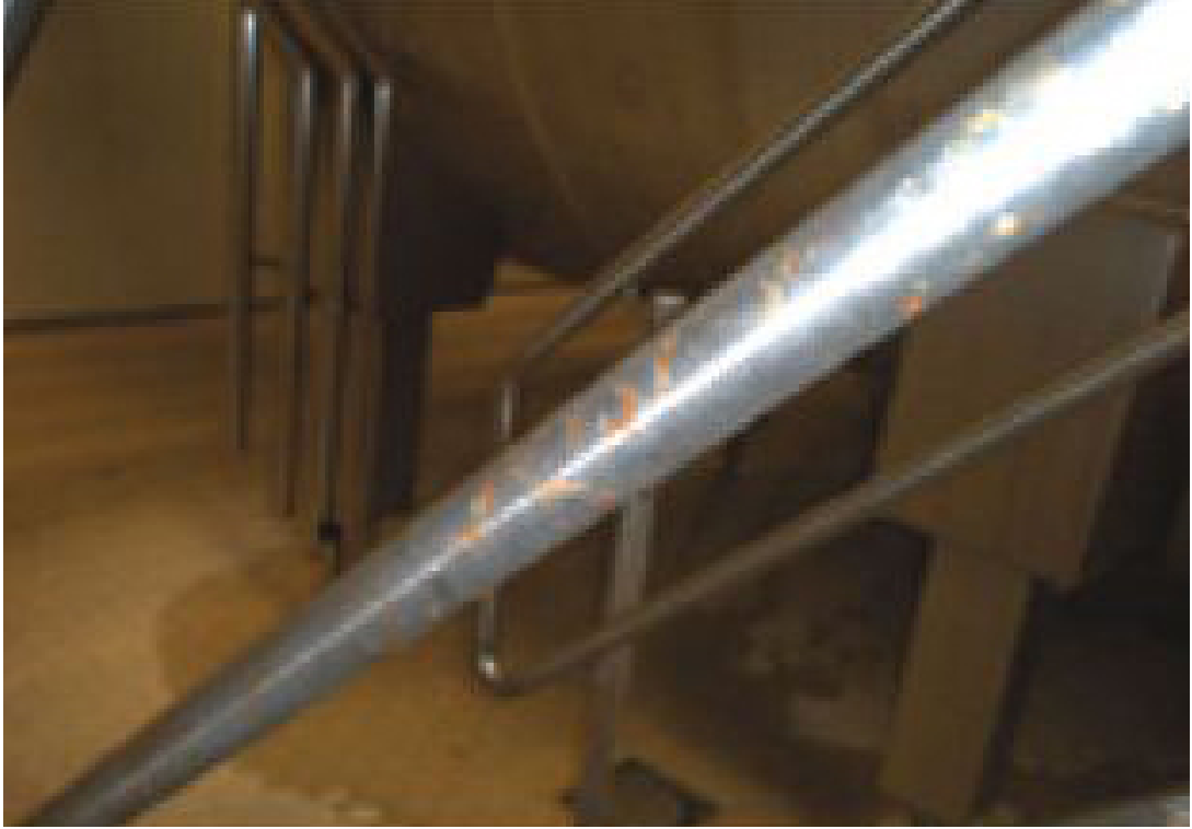
Şekil 4.4: Korozyon tehdidi altında bulunan paslanmaz çelik dikme ( www.demircelik.com.tr )
