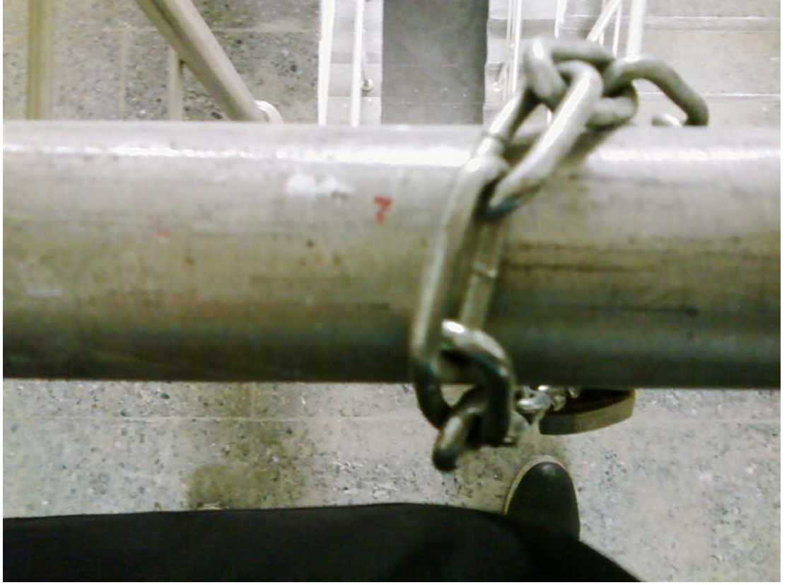
Şekil 5.20: Bakımsızlık nedeniyle pasivasyon tabakası hasar görmüş küpeşte (Gökhan Mermi Arşivi)
