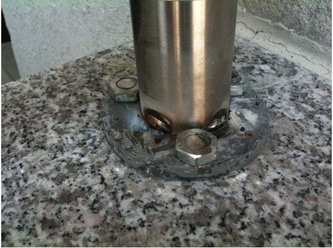
Şekil 5.8: Hatalı kaynak uygulaması (Gökhan Mermi Arşivi)
