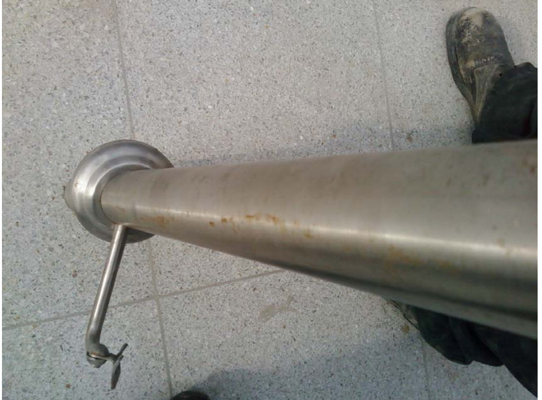
Şekil 5.21: Bakımsızlık nedeniyle pasivasyon tabakası hasar görmüş dikme (Gökhan Mermi Arşivi)
