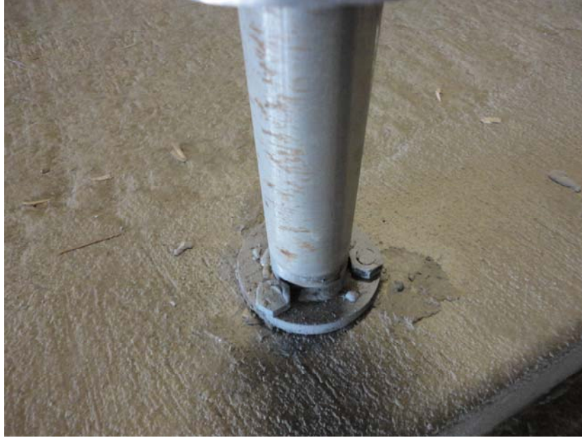
Şekil 4.3: Korozyon tehdidi altında bulunan paslanmaz çelik dikme (Gökhan Mermi Arşivi)
