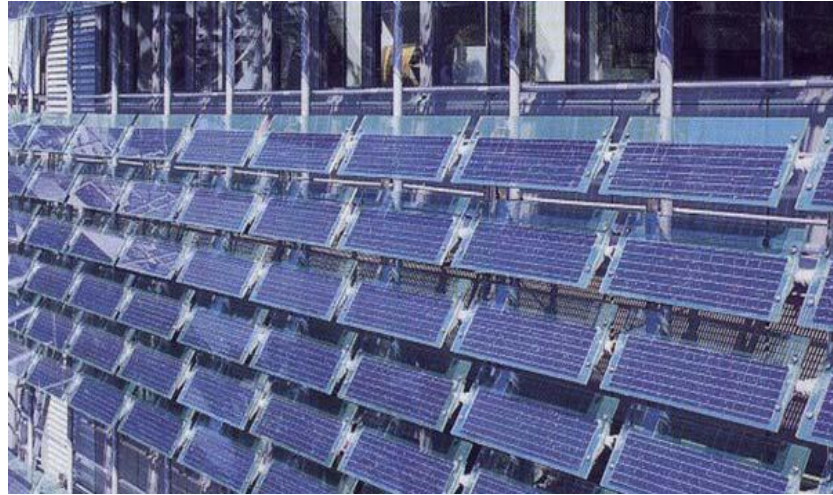
Şekil 3.54. Pv panellerin cephedeki uygulama alanları
