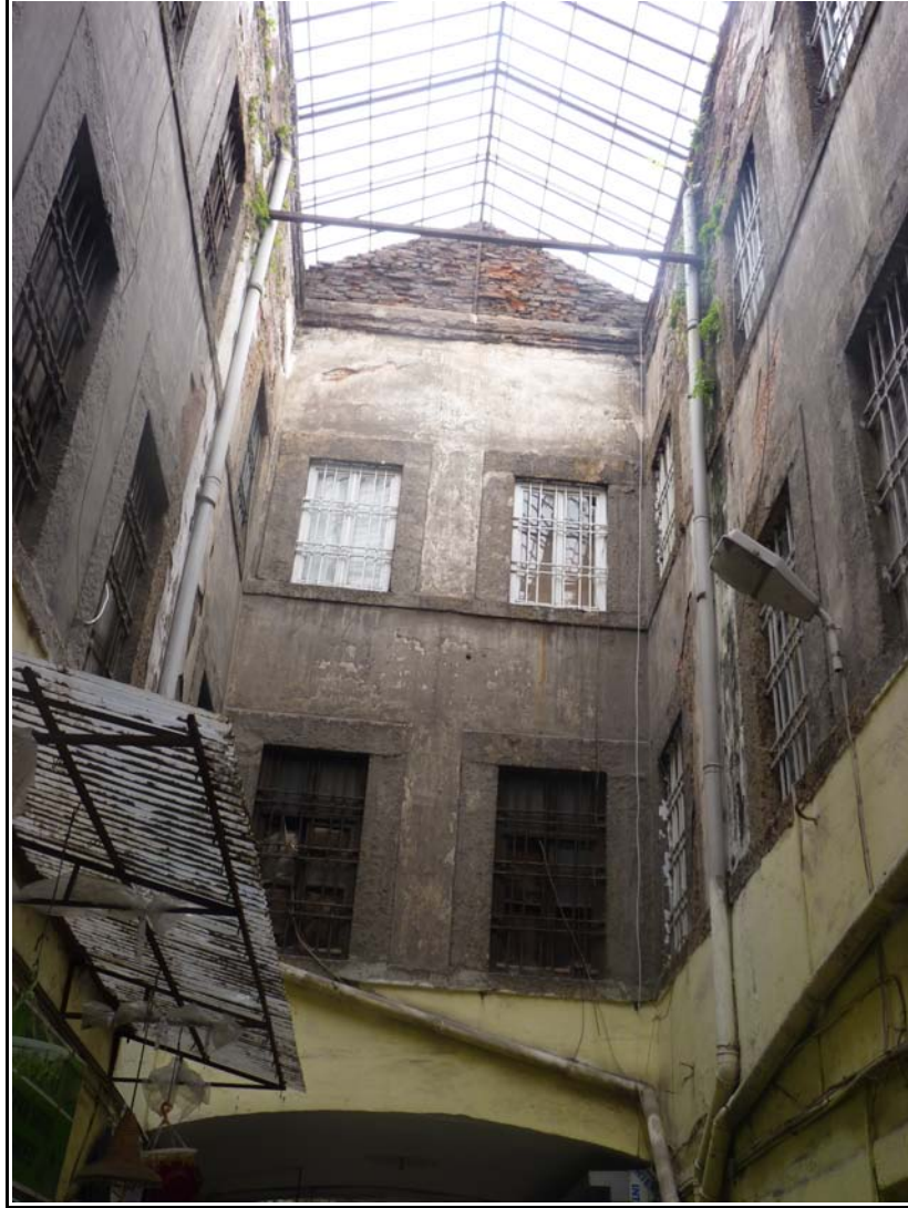
Resim 3.59. Büyük Ticaret Han avlu üstü örtü sistemi ve avluya bakan oda görünümü
