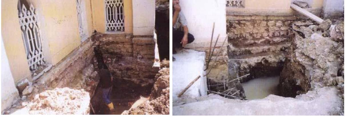
Şekil.28: Eğitim Binası Kuşaklama Perdesi Kazısı; Yetersiz Temel Derinliği
