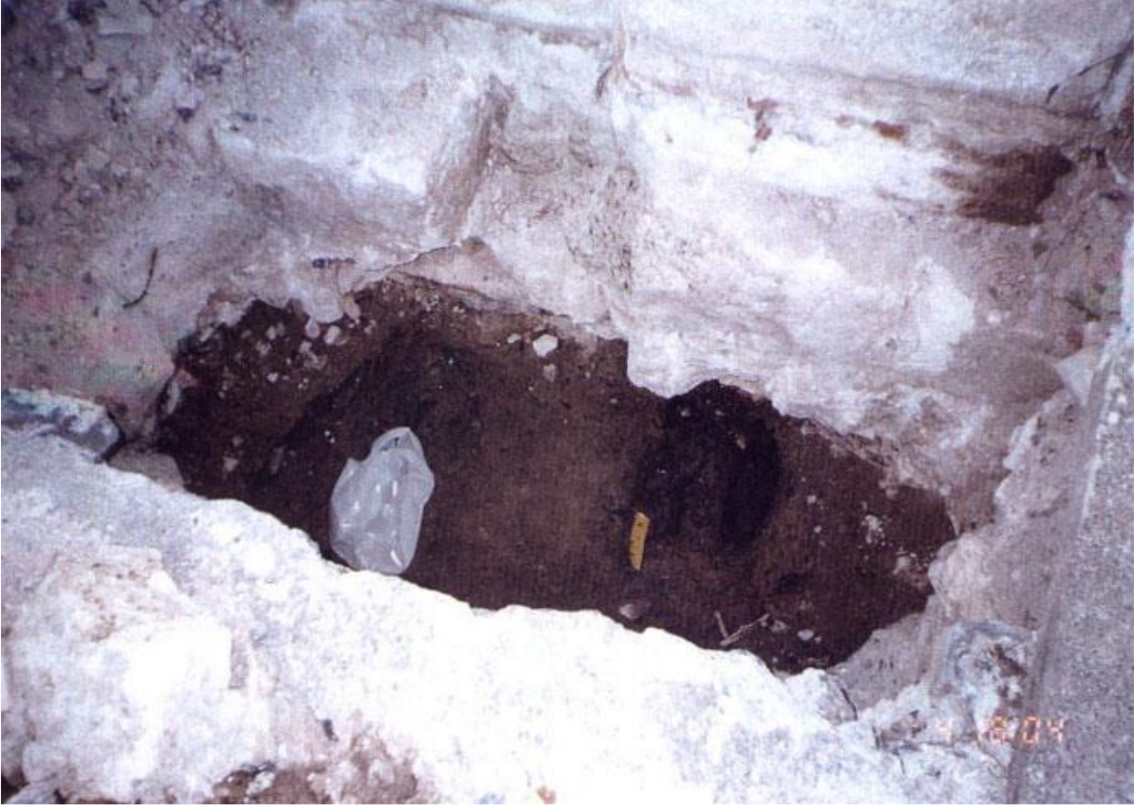
Şekil.25: Eğitim Binası Ön Cephe Muayene Çukuru; Temelin Sağlığı ve Ayrışmış Ahşap Kazıklar Görülmekte.
