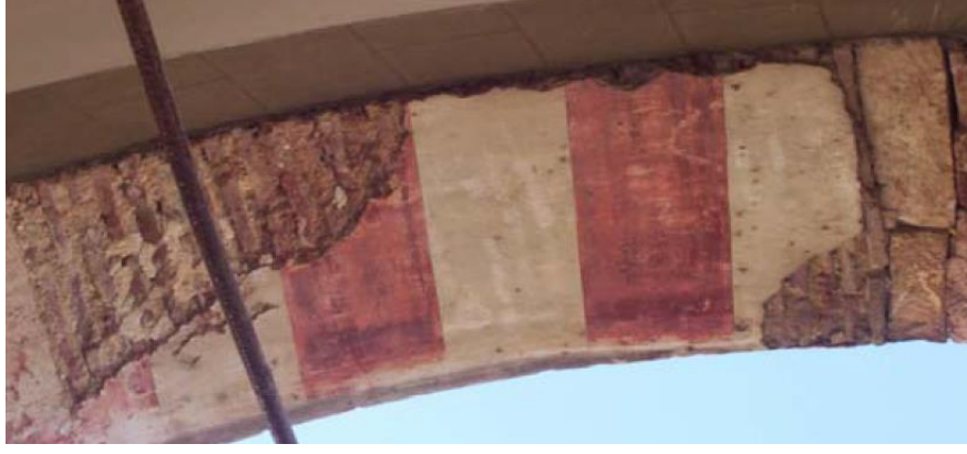
Şekil.13: Revaklarda Görülen Dökülme ve Kılcal Çatlaklar
