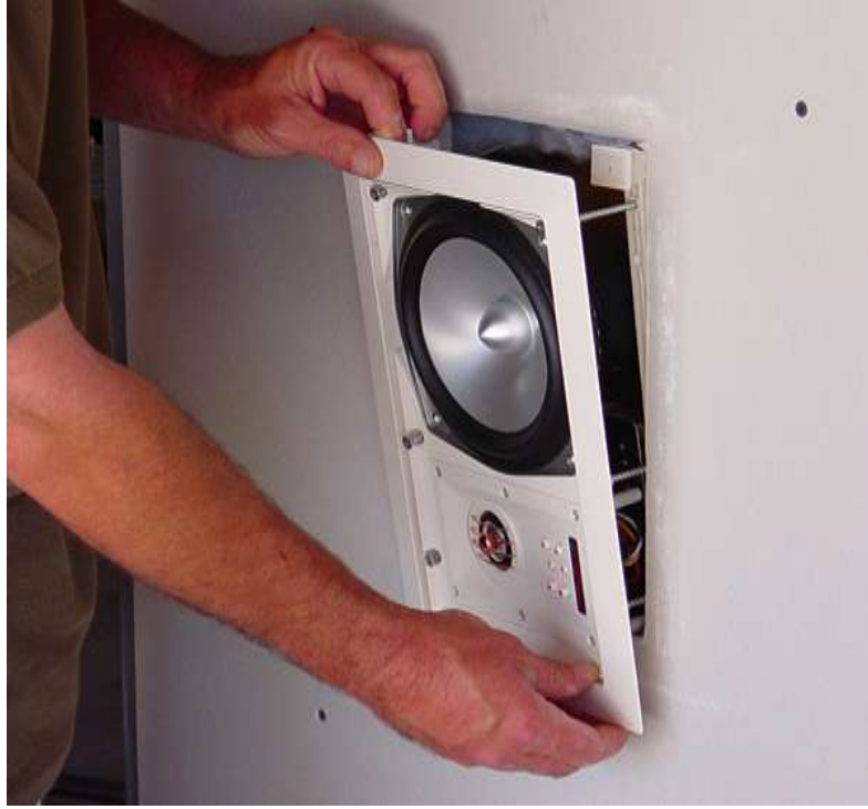
Resim 3.38. Duvara ankastre montajı yapılan speaker
