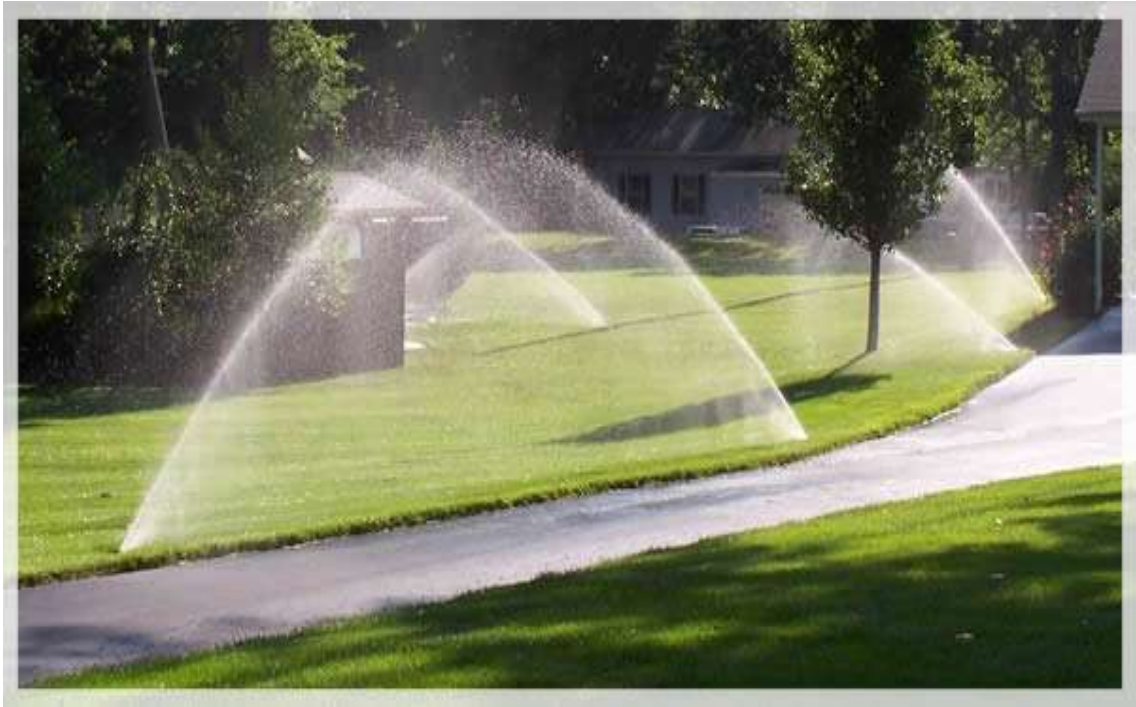
Resim 3.52. Sprinkler bahçe sulama sistemi
