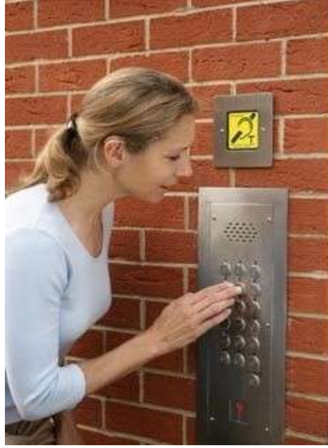
Resim 3.32. Kapı Girişinde Kameralı Görüşme Sistemi
