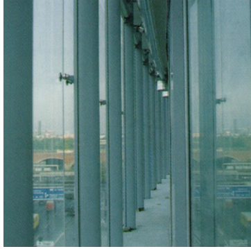
Şekil 9.17 – Storların ve havalandırma kanalının görünüşü
