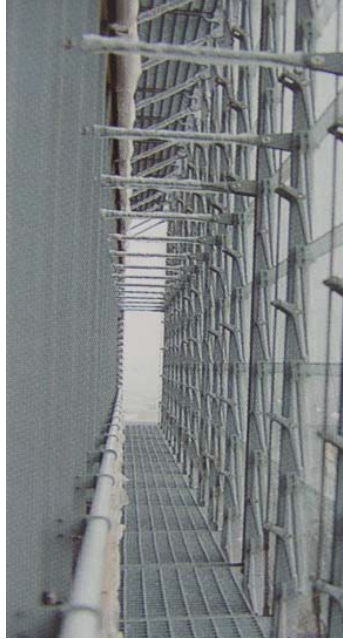
Şekil 9.37 – Havalandırma boşluğu ve servis koridoru
