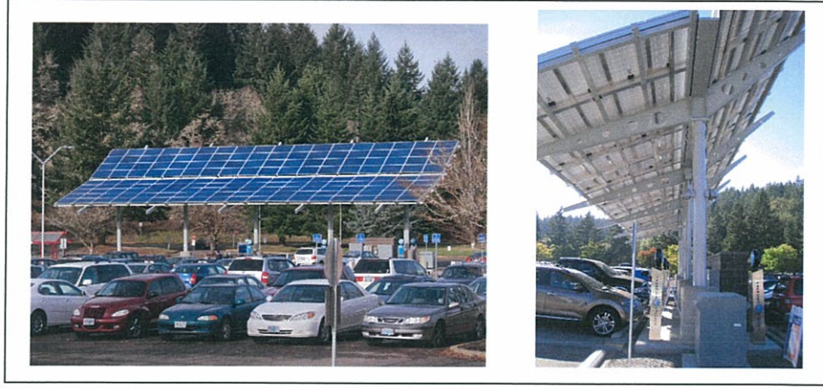
Şekil 4.19. Elektrikli Araçlar İçin Güneş Enerjili Şarj İstasyonu (Lane Community College., 2014).
