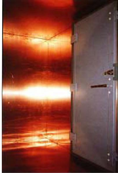
Şekil 7. 3 MR odası bakır kalkan uygulaması 2
