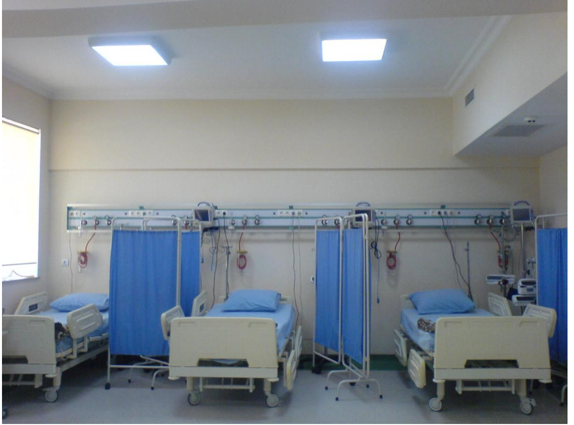
Şekil 3. 7 Acil odası aydınlatması
