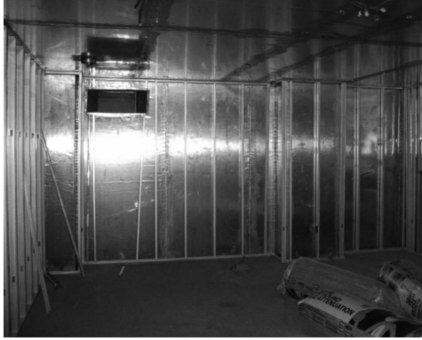
Şekil 7. 2 MR odası bakır kalkan uygulaması 1
