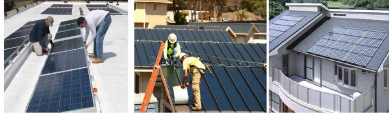
Şekil 5.4. Çatılarda PV uygulaması [6]
