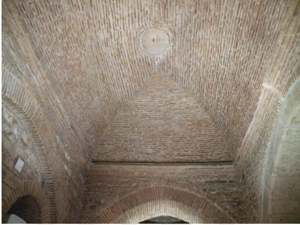
Şekil 5. 9.: Raspası Yapılarak Özgün Tuğla Örgüsü Ortaya Çıkarılan Tonoz Kaynak 5. 9.: Selcem Bayır Arşivi
