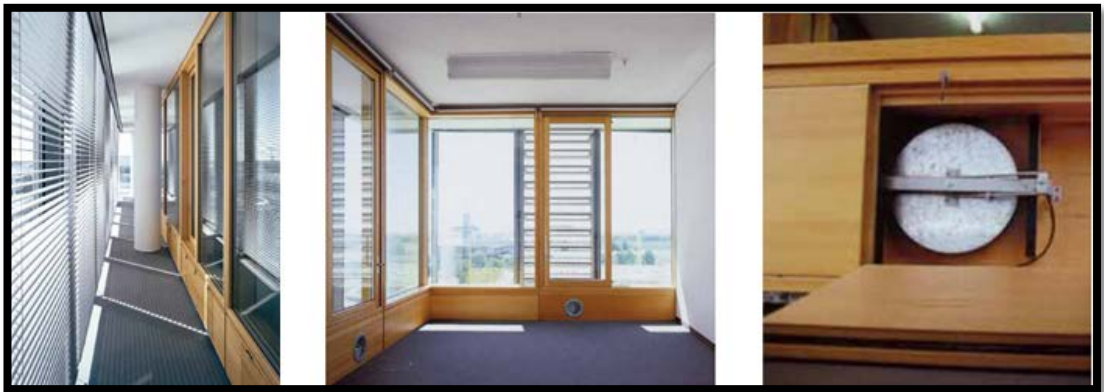
Şekil 2.19. Deutsche Messe Ag Binasının havalandırma boşluğu, iç mekan ve havalandırma kanalı fotoğrafları (Lang, 2005)
