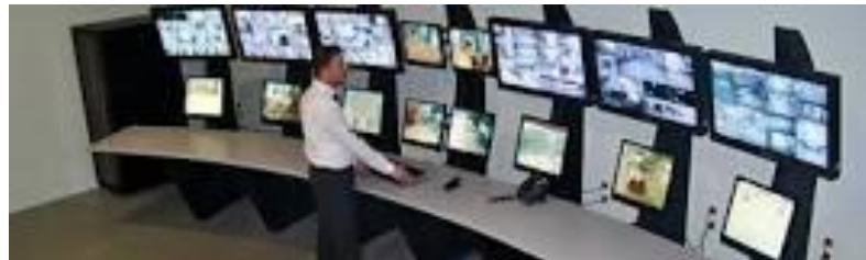
Resim 9. Bina Güvenlik Komuta Merkezi
